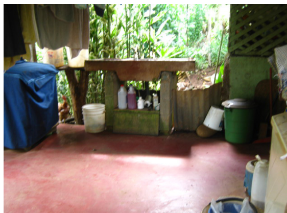
Imagen [2] 75. Piso de concreto lujado. Fuente propia.
