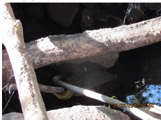
Imagen [2] 20. Toma de agua de nacientes en La Tinta. Fuente propia.
