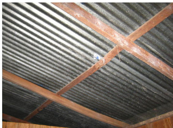
Imagen [2] 80. Estructura de cubierta de madera y láminas de HG sin cielo raso. Fuente: UR-PHED.
