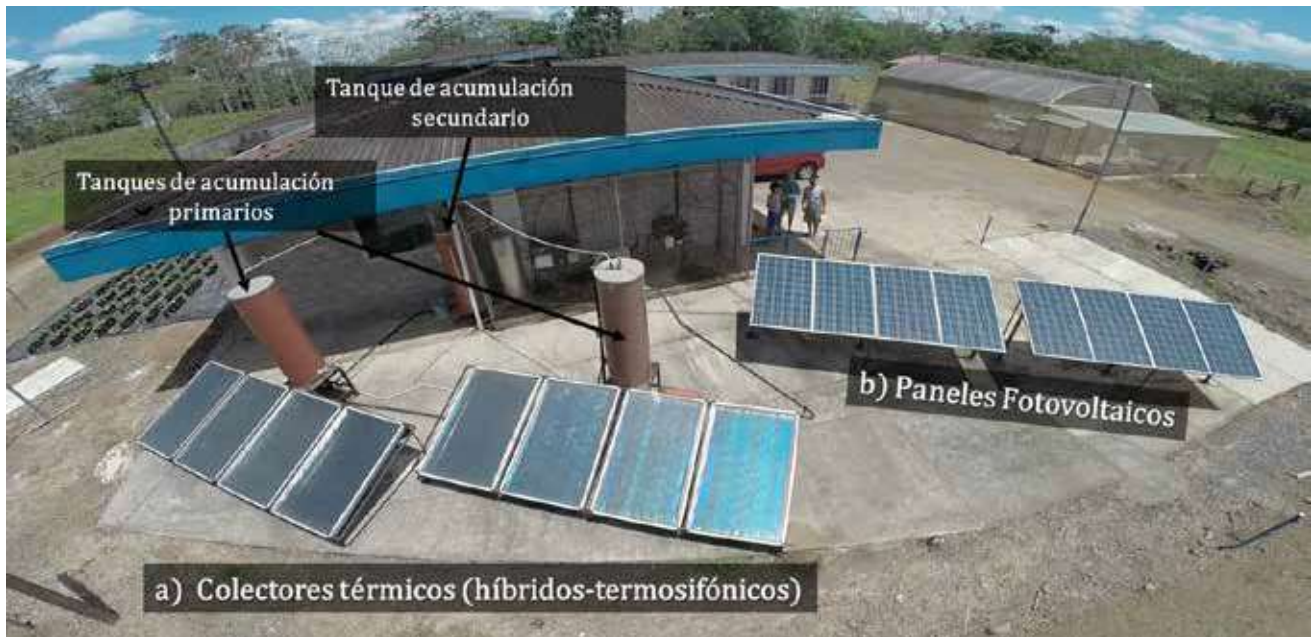
Figura. 4. Sistemas solares implantados en la lechería ITCR-SSC.
