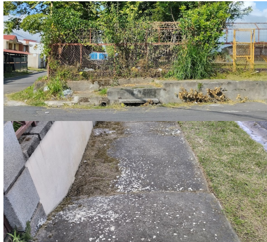
Figura 3.14. Aceras en mal estado y diseño deficiente (no accesibilidad universal)
