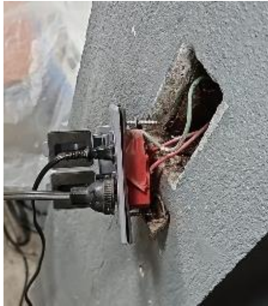
Figura 15: Tomacorriente expuesto Fuente: La Nacional S.A
