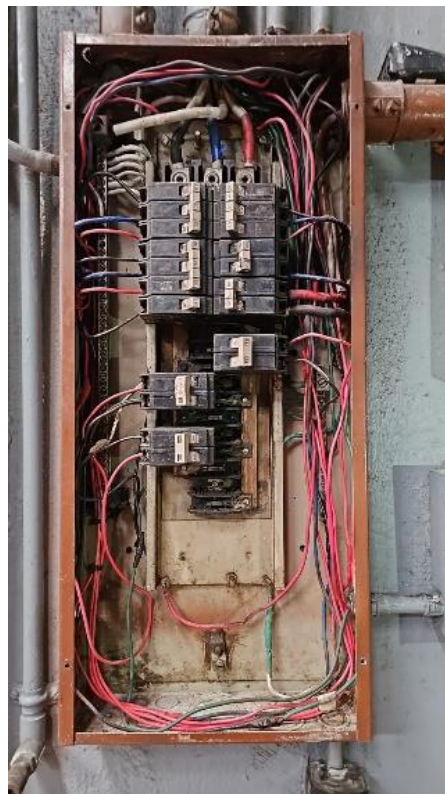
Figura 16: Tablero sin conexión a tierra Fuente: La Nacional S.A
