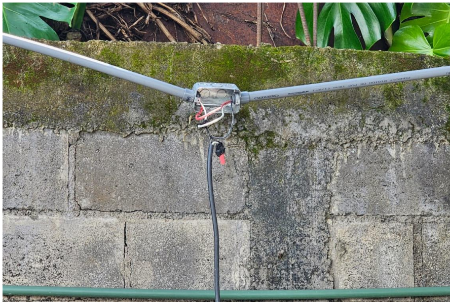
Figura 18: Caja expuesta con unión de cables para alimentación del motor del portón eléctrico Fuente: La Nacional S.A
