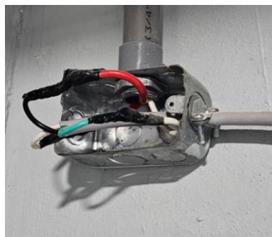
Figura 14: Tomacorriente con cables unidos
