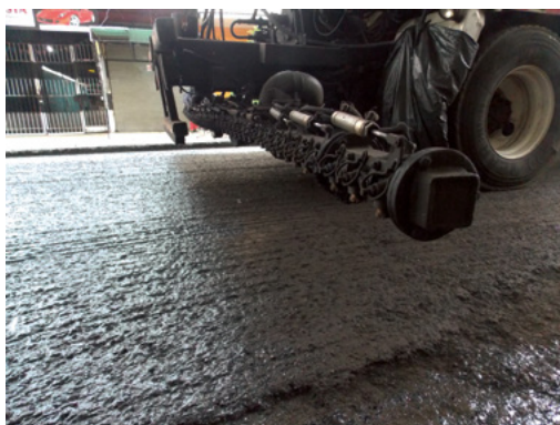
Figura 28. Limpieza y buen estado del equipo
