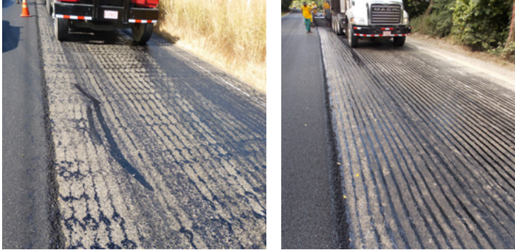
Figura 48. Cobertura no uniforme (riego de liga en rayas) producto de incorrecta altura de la barra rociadora y/o inadecuada presión del bombeo de emulsión
