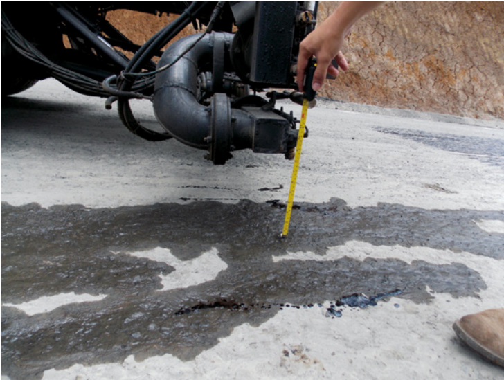
Figura 31. Medición de la altura de la barra rociadora respecto a la superficie
