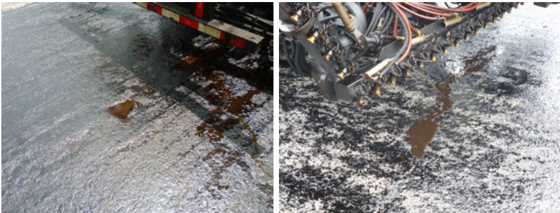
Figura 57. Derrame de emulsión asfáltica debido a fugas en la barra rociadora del camión dosificador
