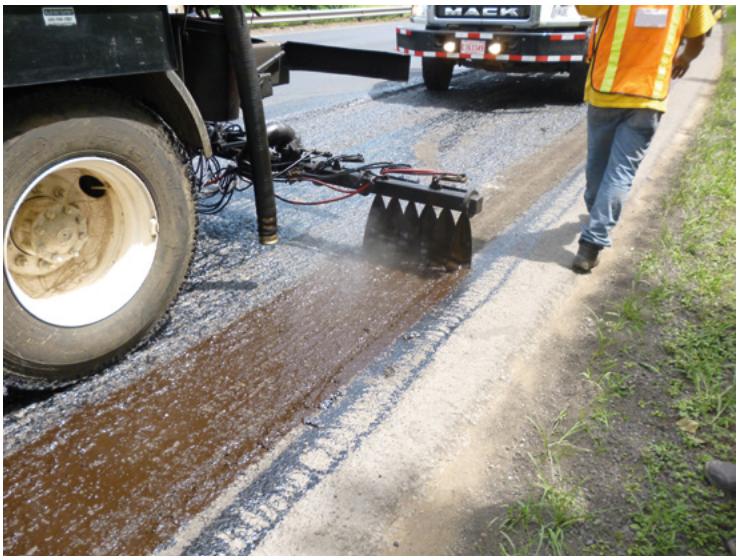
Figura 33. Cobertura triple del material, re aplicación de emulsión en área donde se perdió el riego de liga
