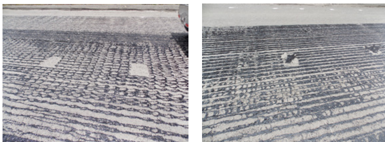
Figura 52. Tasas de aplicación de emulsión asfáltica menores a las señaladas por la ingeniería de proyecto. La cobertura del riego de liga de las áreas ensayadas es deficiente
