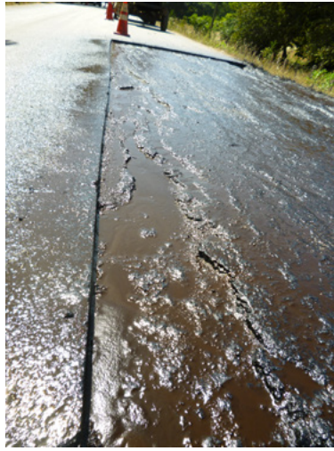
Figura 55. Riego de liga excesivo
