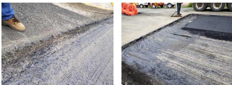
Figura 53. Cobertura deficiente en las juntas longitudinales y transversales
