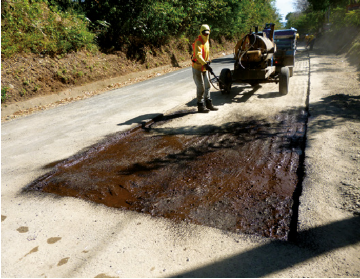
Figura 40. Riego de liga excesivo para compensar superficie empolvada
