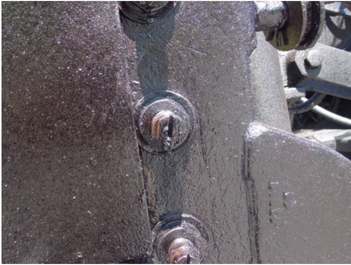
Figura 42. Ausencia de limpieza y obstrucción de boquillas
