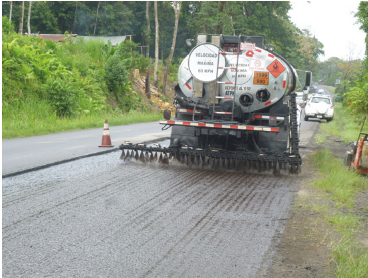
Figura 32. La aplicación del riego de liga es uniforme y homogénea, con paredes recubiertas
