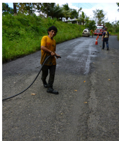
Figura 54. Aplicación manual del riego de liga sin equipo de seguridad
