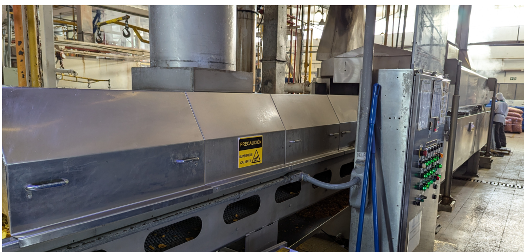
Figura 4.24: Vista lateral del área de trabajo de la freidora 5.
