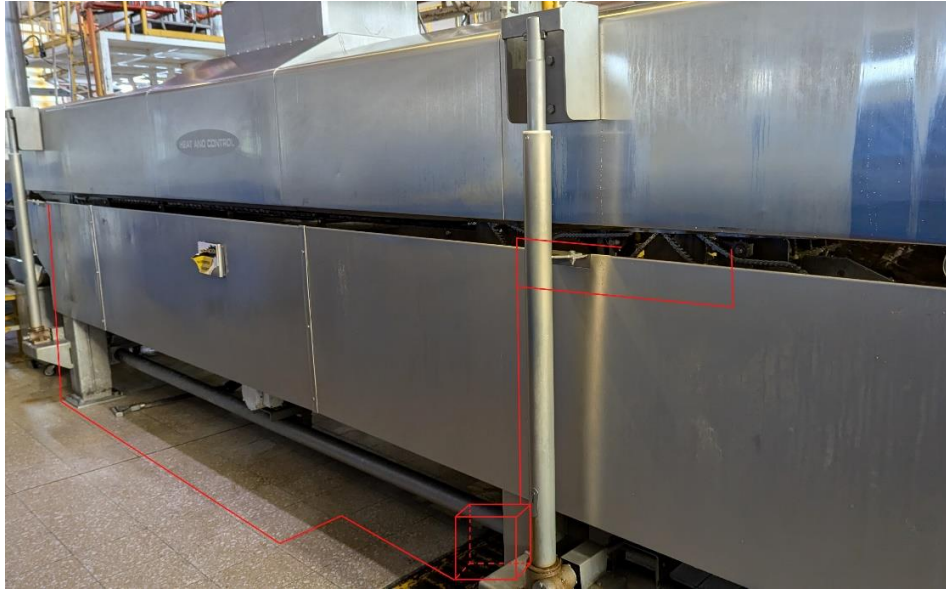
Figura 8: Posicionamiento de la carcasa (caja roja) y cableado (líneas rojas) en el freidor #5.
