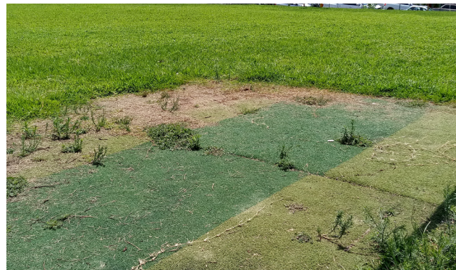
Figura 75. Deterioro de la plaza de fútbol [Fotografía], por Autoría propia.
