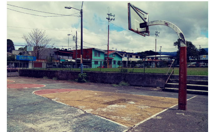
Figura 78. Deterioro de canchas de baloncesto [Fotografía], por Autoría propia.
