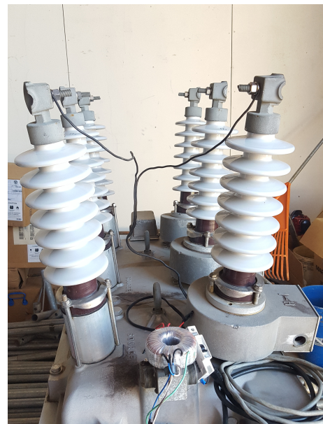
Figura 87: Transformador e interruptor
