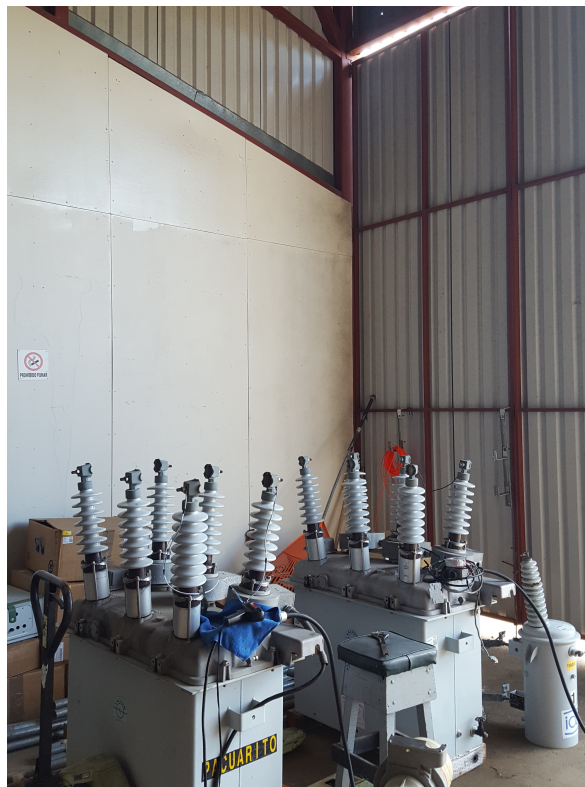
Figura 91: Interruptores de prueba
