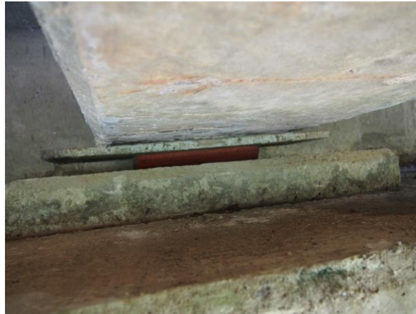
Figura 20: Rotura de apoyos – Grado 5 Fuente: PEEP
