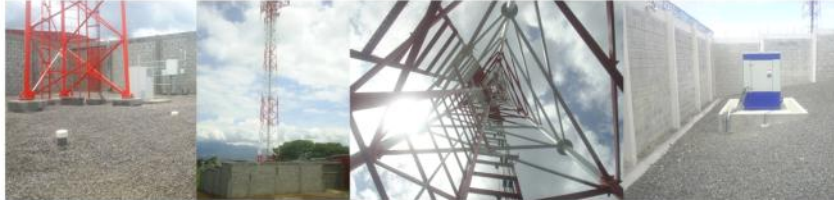
Figura 1.3 Panorámica interna de sitio de torre Fuente: Elaboración propia del grupo técnico
