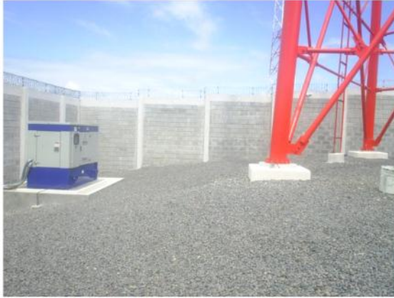
Figura Ap.3 Panorámica interna de sitio de torre en Limón Fuente: Elaboración propia del grupo técnico
