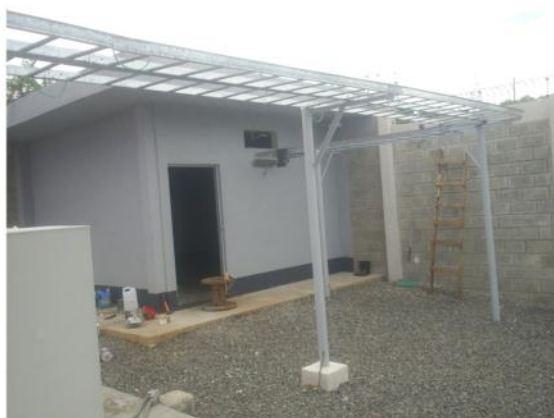
Figura Ap.2 Caseta de equipos en sitio de torre en Limón Fuente: Elaboración propia del grupo técnico
