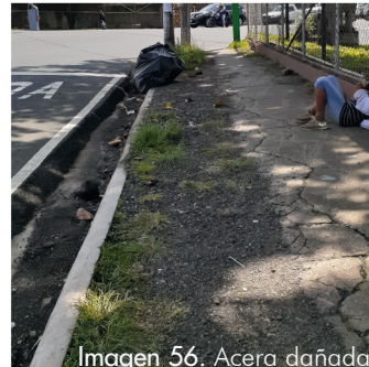
Imagen 56. Acera dañada. Autoría propia.
