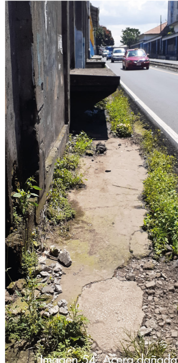
Imagen 54. Acera dañada. Autoría propia.
