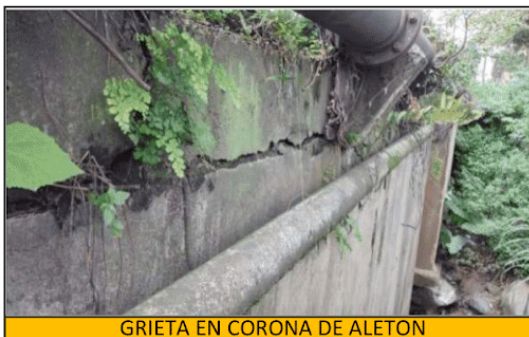
GRIETA EN CORONA DE ALETON
