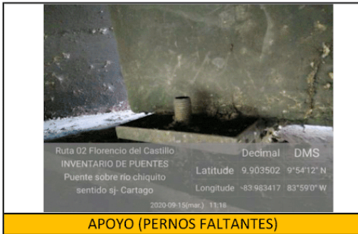
APOYO (PERNOS FALTANTES)
