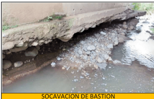
SOCAVACION DE BASTION
