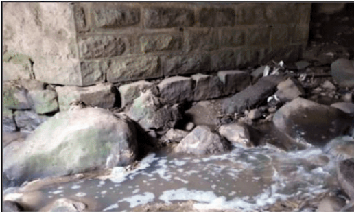
SOCAVACION DE BASTION
