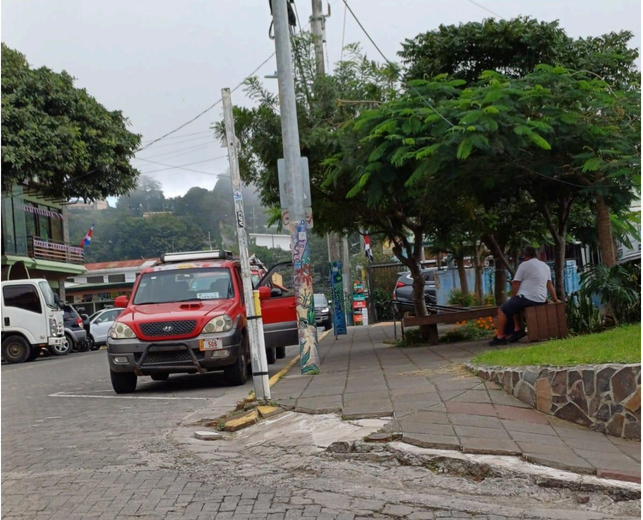
Figura 69. Acera sobre la RC-612040 Santa Elena centro 4.
