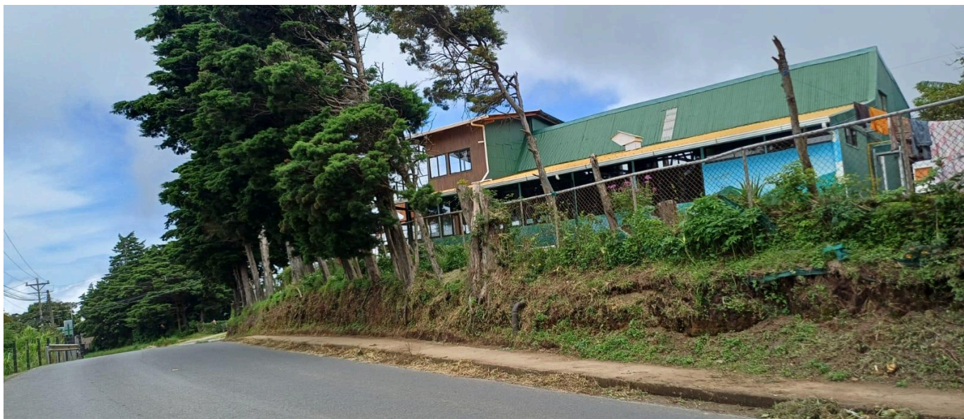
Figura 57. Acera sobre la RN-606 tramo entre entronques con RC-612011 y RN-620 pt.1.
