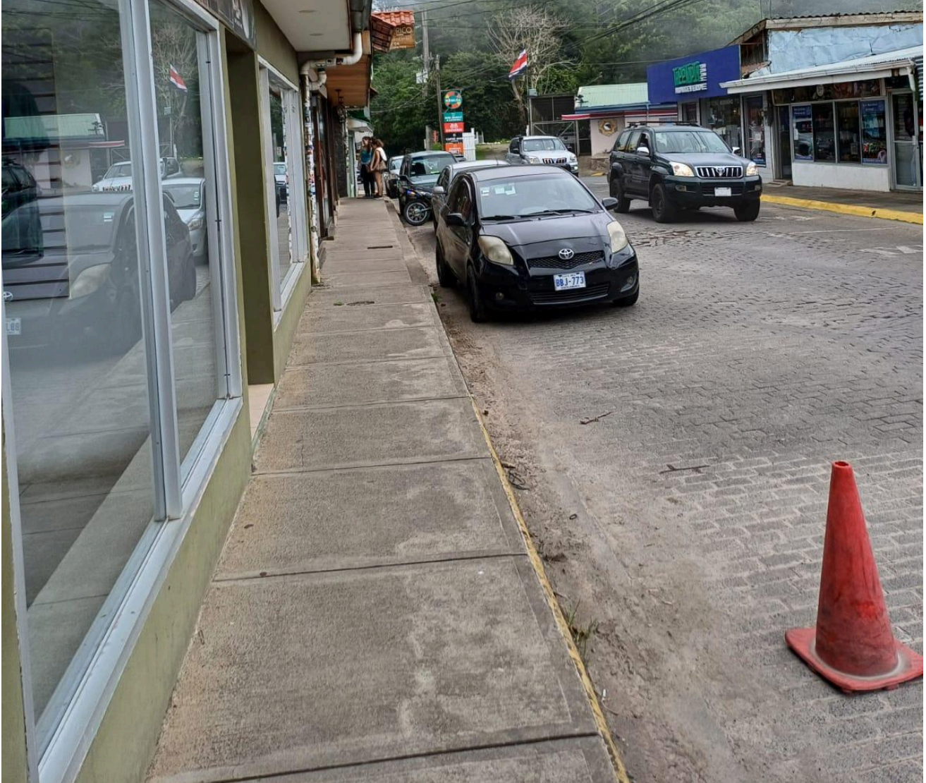
Figura 67. Acera sobre la RC-612040 Santa Elena centro 2.
