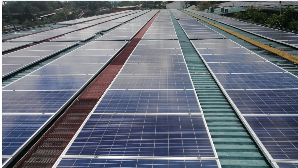
Figura 1.3: Sistema de paneles solares de las oficinas centrales de Coopesantos R.L.
