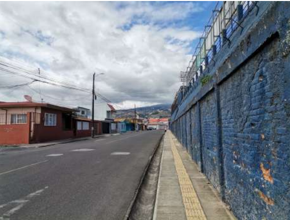
Figura 64: Fotografía del muro del estadio colindante a la acera Fuente: Elaboración propia. Sabrina Izabá Aguilar.
