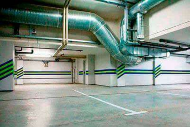
Figura 118: Ilustración de sistema de extracción de gases Fuente: Aire acondicionado en Perú.
