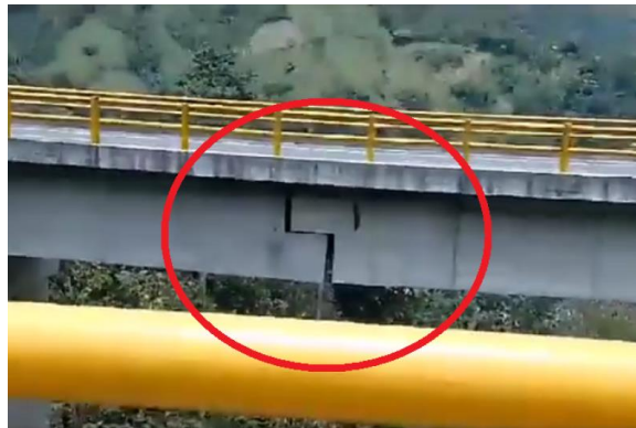
Grietas en puente de Medellín
