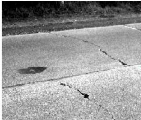
Figura 26. Agrietamiento transversal de losa. Fuente: Sánchez, 2009.
