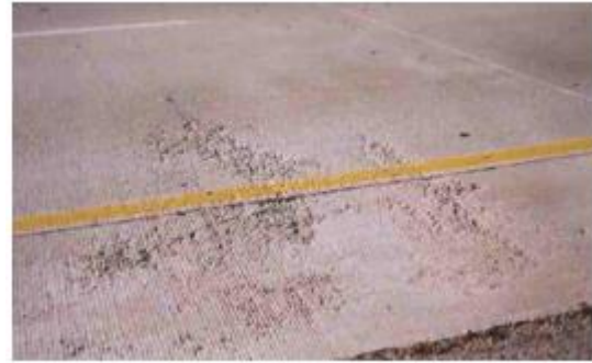
Figura 30. Desintegración superficial y fisuras capilares. Fuente: Sánchez, 2009.
