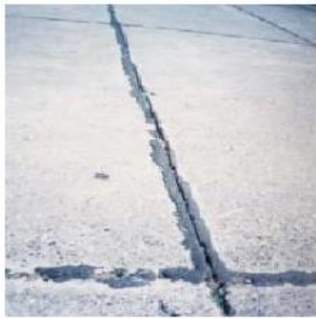
Figura 31. Pérdida del sello en las juntas. Fuente: Sánchez, 2009.
