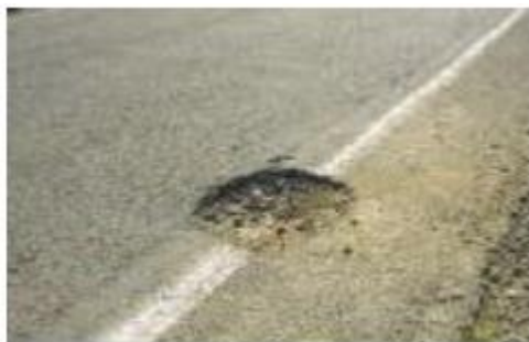
Figura 20. Bache sobre la carretera. Fuente: Miranda, 2010.
