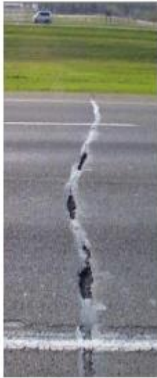
Figura 17. Agrietamiento transversal. Fuente: Sánchez, 2009.
