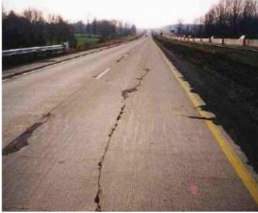
Figura 25. Agrietamiento longitudinal de losa. Fuente: Sánchez, 2009.
