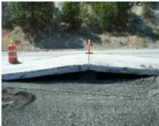
Figura 29. Levantamiento entre losas adyacentes. Fuente: Sánchez, 2009.
