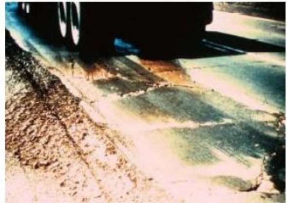
Figura 33. Surgencia de finos en la superficie del pavimento. Fuente: Sánchez, 2009.
