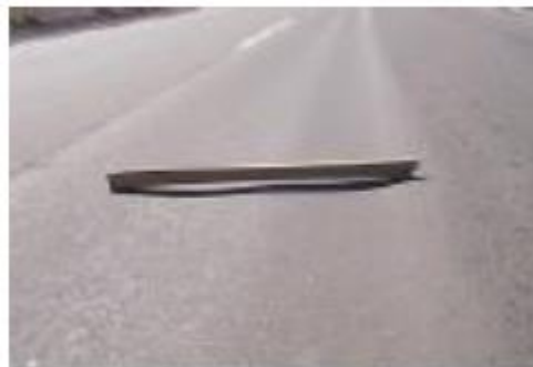
Figura 21. Ahuellamiento. Fuente: Miranda, 2010.
