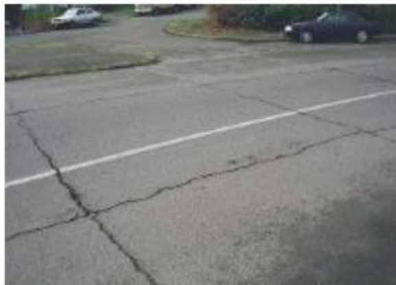
Figura 19. Agrietamiento por reflexión. Fuente: Sánchez, 2009.
