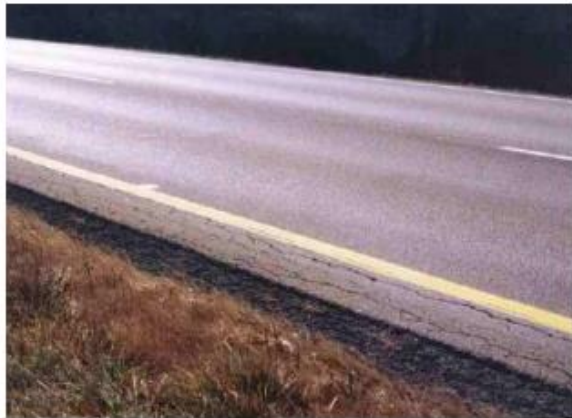
Figura 15. Agrietamiento de borde. Fuente: Sánchez, 2009.
