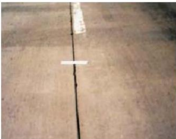
Figura 32. Separación de la junta longitudinal. Fuente: Sánchez, 2009.
