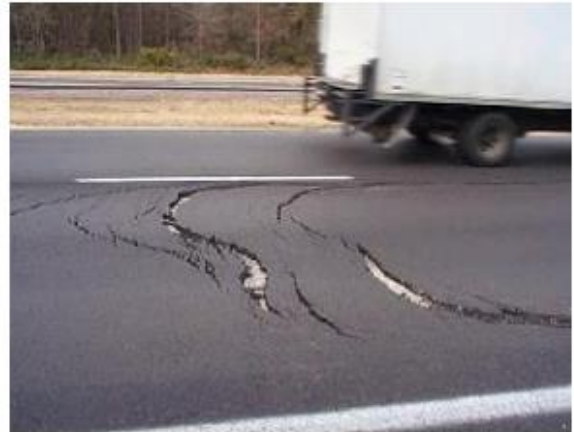
Figura 18. Agrietamiento parabólico. Fuente: Sánchez, 2009.
