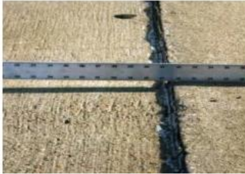
Figura 28. Escalonamiento entre losas adyacentes. Fuente: Sánchez, 2009.
