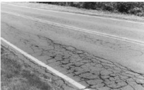
Figura 13. Agrietamiento tipo piel de cocodrilo. Fuente: Sánchez, 2009.
