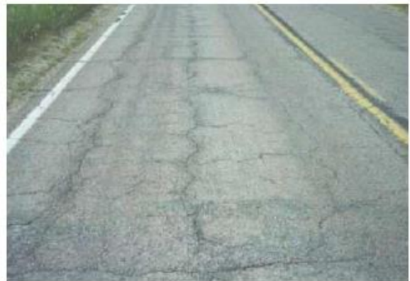
Figura 14. Agrietamiento en bloque. Fuente: Sánchez, 2009.
