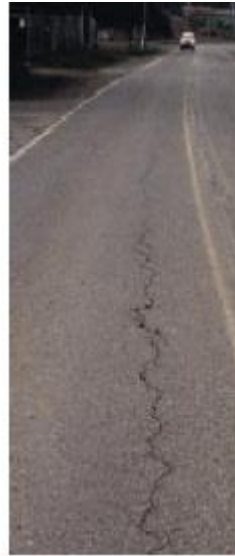
Figura 16. Agrietamiento longitudinal. Fuente: Sánchez, 2009.
