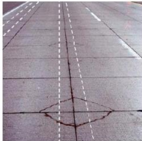
Figura 27. Agrietamiento en la esquina de la losa. Fuente: Sánchez, 2009.
