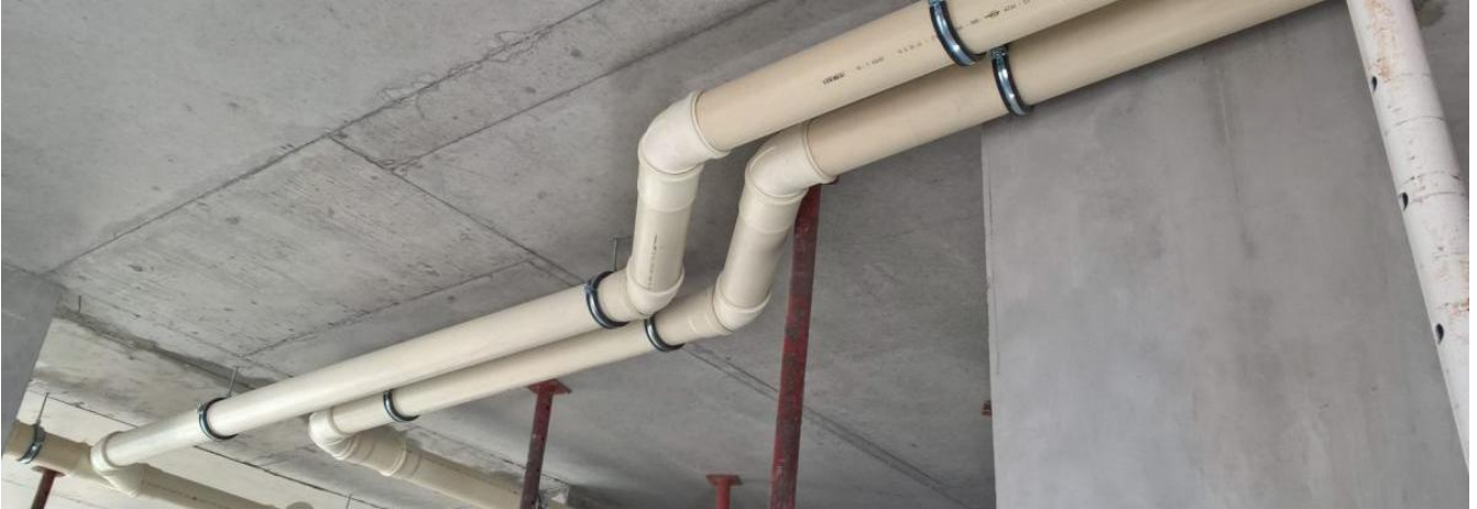
Figura 19 Ejemplo Tuberías Colgantes
