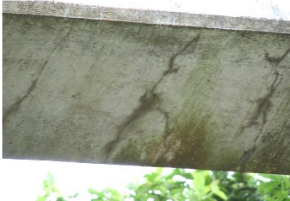
Figura 47. Grietas en una dirección en viga de concreto (MOPT, 2007).
