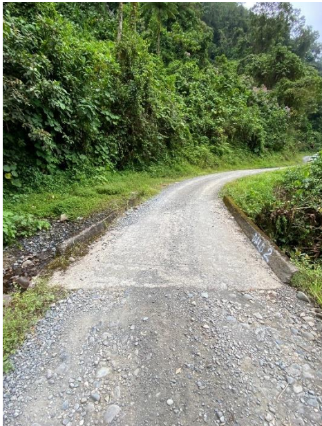
Figura A19. Ausencia de la baranda. Autoría propia.
