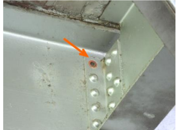
Figura 45. Pérdida de perno en viga de acero (MOPT, 2007).
