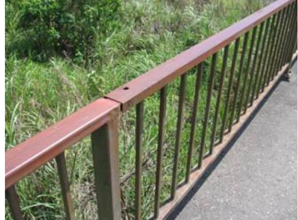
Figura 31. Corrosión en baranda de acero (MOPT, 2007).
