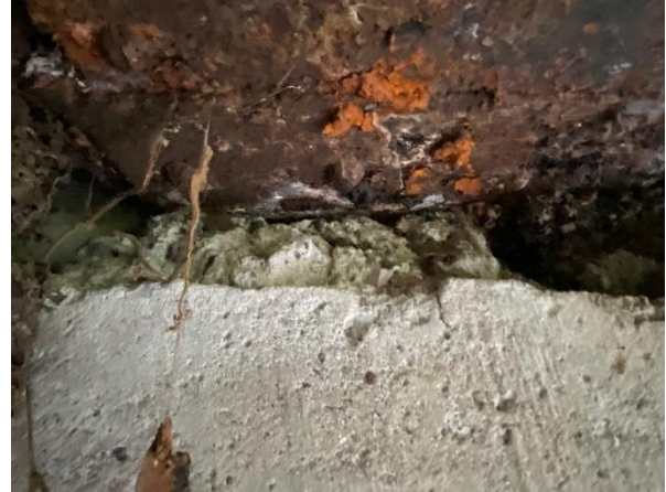
Figura A96. Oxidación y corrosión de las vigas principales. Autoría propia.
