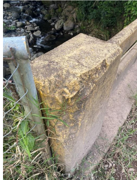
Figura A26. Daños en las barandas. Autoría propia.
