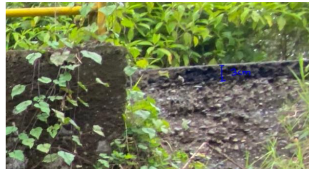
Figura A53. Acercamiento de la sobrecapa de asfalto en la alcantarilla Cruce con San Antonio. Autoría propia.
