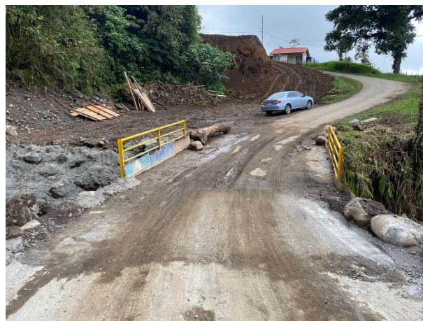
Figura A27. Obstrucción de las juntas de expansión. Autoría propia.
