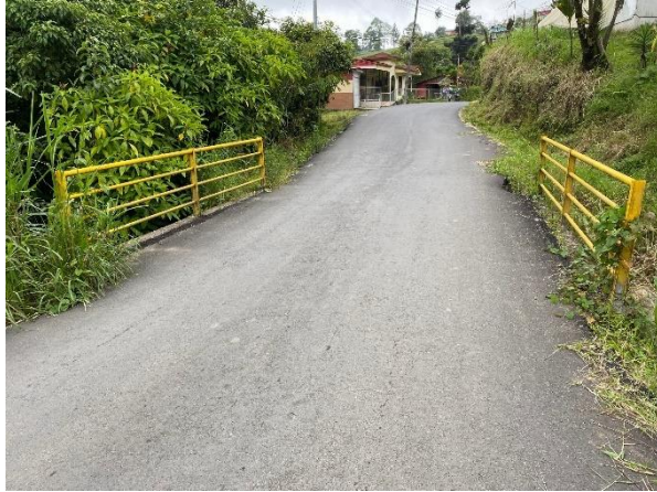
Figura A54. Obstrucción de las juntas de expansión. Autoría propia.
