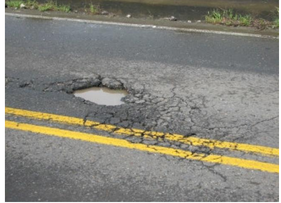
Figura 27. Baches en el pavimento (MOPT, 2007).
