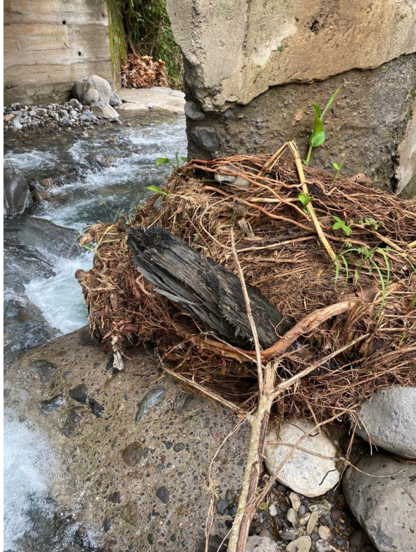
Figura A110. Desprendimiento de concreto en la Pila P1. Autoría propia.
