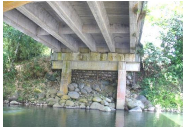
Figura 65. Colapso total de la protección del talud frente al bastión (MOPT, 2007).
