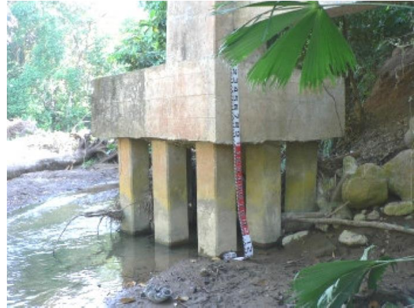
Figura 66. Socavación en la fundación de una pila (MOPT, 2007).
