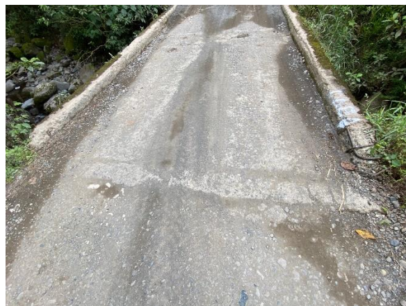
Figura A11. Obstrucción de las juntas de expansión. Autoría propia.
