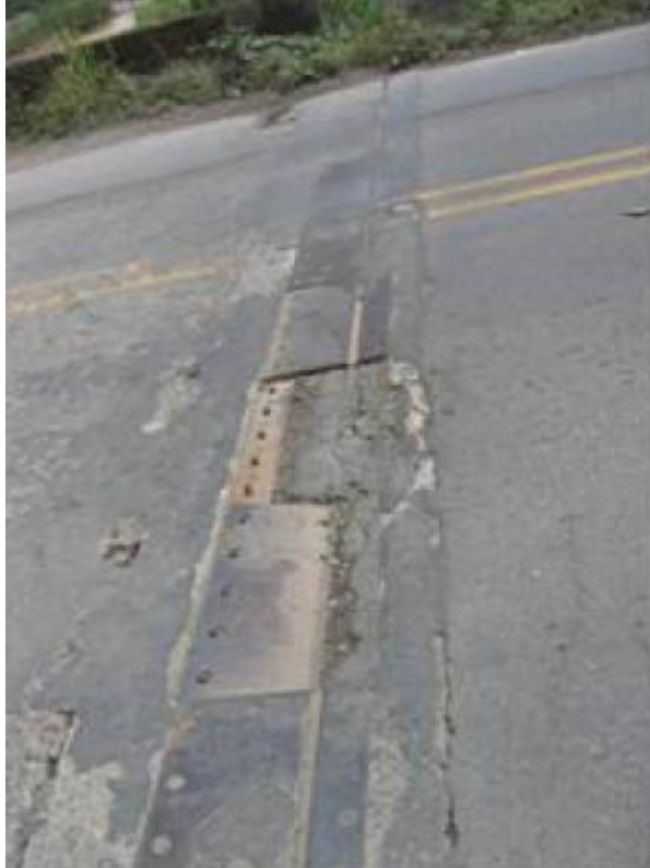
Figura 36. Faltante de parte de la junta de expansión (MOPT, 2007).
