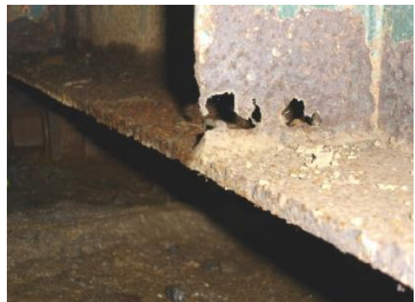
Figura 53. Corrosión en elemento de acero (MOPT, 2007).
