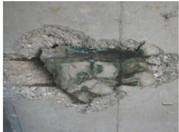
Figura 42. Nidos de piedra en losa de concreto (MOPT, 2007).
