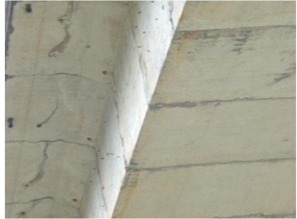
Figura 48. Grietas en dos direcciones en viga de concreto (MOPT, 2007).
