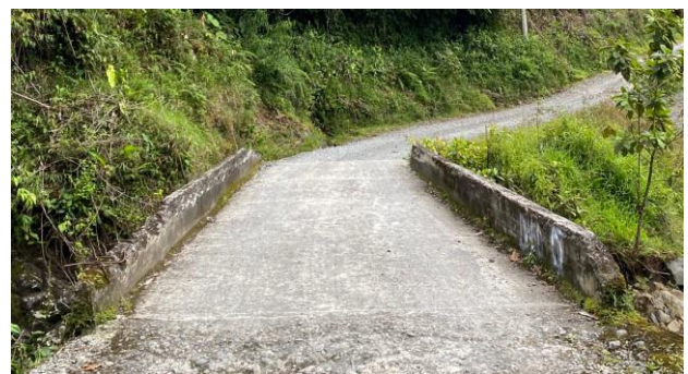
Figura A59. Obstrucción de las juntas de expansión. Autoría propia.
