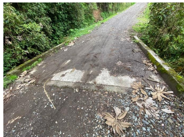
Figura A40. Obstrucción de las juntas de expansión. Autoría propia.
