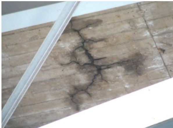
Figura 40. Grietas en dos direcciones en losa de concreto (MOPT, 2007).
