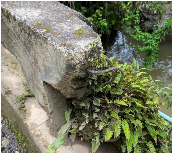
Figura 34. Acero de refuerzo expuesto en baranda de concreto (Autoría propia, 2021).
