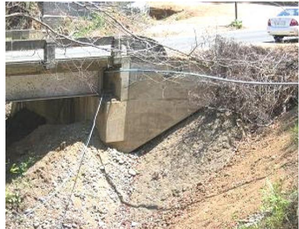
Figura 62. Relleno de aproximación del aletón colapsado (MOPT, 2007).
