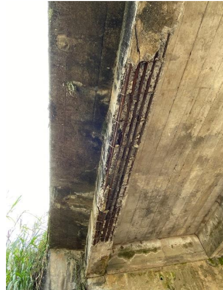
Figura A29. Daños en las vigas principales. Autoría propia.
