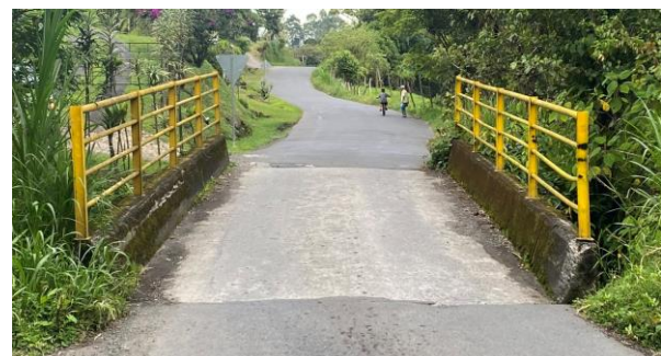
Figura A67. Obstrucción de las juntas de expansión. Autoría propia.
