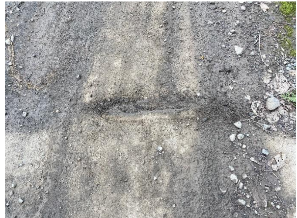
Figura A103. Obstrucción en la junta central del puente. Autoría propia.
