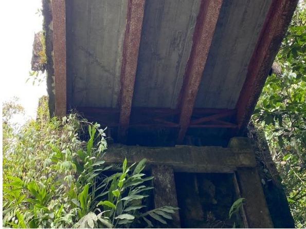
Figura A48. Oxidación y corrosión de las vigas principales. Autoría propia.
