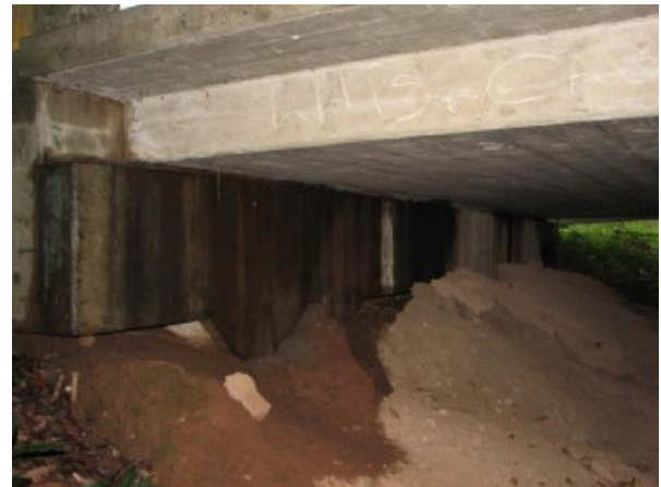
Figura 35. Filtración de agua por medio de la junta de expansión (MOPT, 2007).
