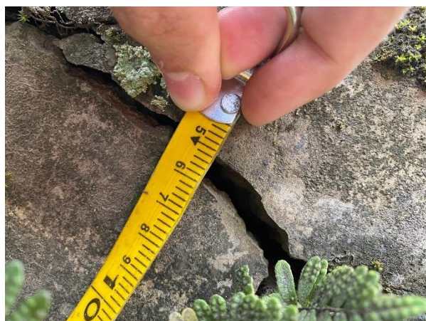
Figura A127. Grieta de 1cm en baranda. Autoría propia.
