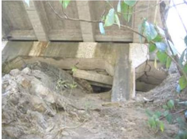
Figura 63. Colapso de la protección enfrente del bastión (MOPT, 2007).
