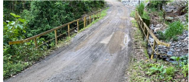
Figura A102. Obstrucción de las juntas de expansión. Autoría propia.
