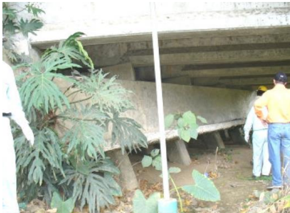
Figura 64. Inclinación del bastión por sismo (MOPT, 2007).
