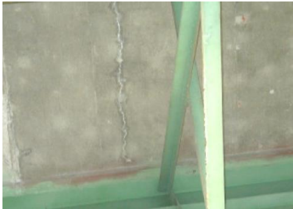
Figura 39. Grieta en una dirección en losa de concreto (MOPT, 2007).
