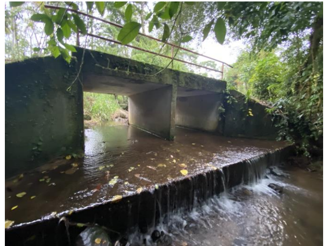
Figura 3. Alcantarilla con dos celdas rectangulares, aletones y delantal. (Autoría propia, 2021).
