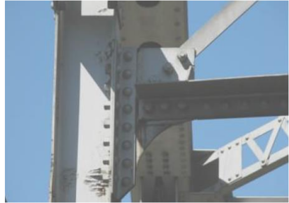
Figura 56. Descascaramiento de pintura en elemento de cercha (MOPT, 2007).
