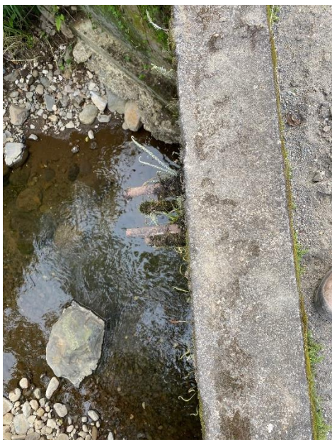
Figura A3. Ausencia de la baranda. Autoría propia.
