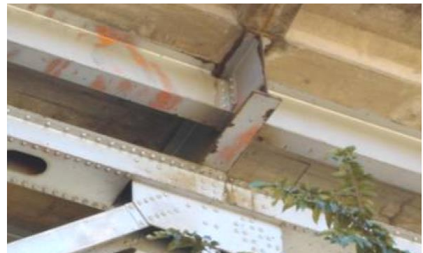
Figura 52. Oxidación en borde filoso de elemento de acero (MOPT, 2007).
