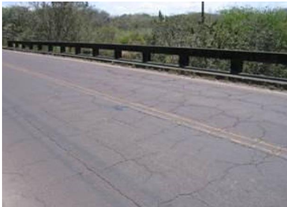
Figura 26. Grietas en el pavimento (MOPT, 2007).
