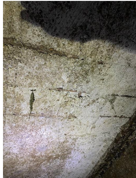
Figura 41. Acero de refuerzo expuesto en losa de concreto, Puente Bonillita (Autoría propia, 2021).
