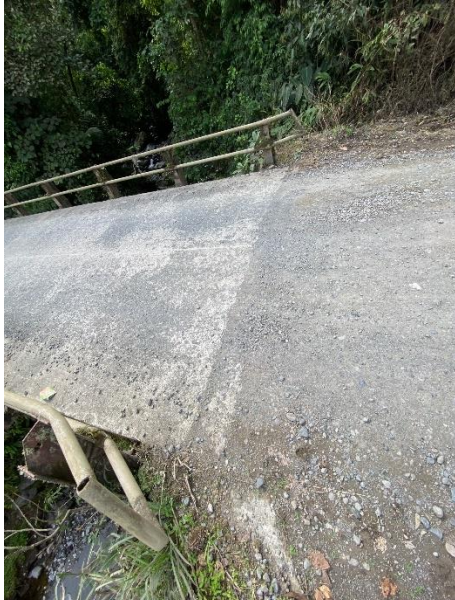
Figura A47. Obstrucción de la J2 de expansión. Autoría propia.
