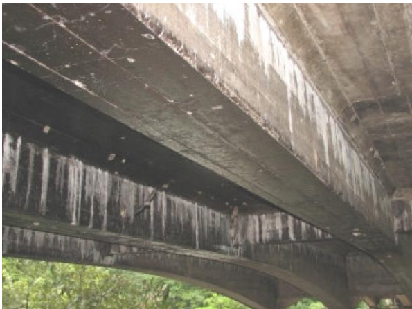
Figura 51. Eflorescencia en vigas de concreto (MOPT, 2007).
