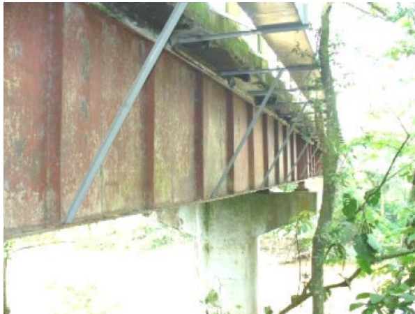
Figura 55. Decoloración de la viga principal de acero (MOPT, 2007).
