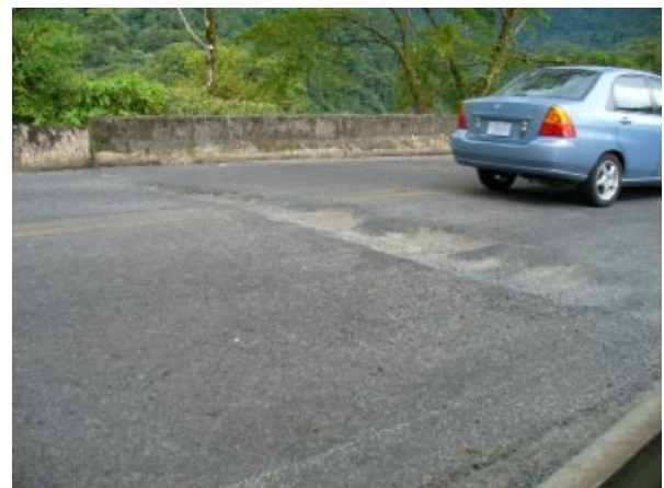
Figura 24. Ondulación en el pavimento (MOPT, 2007).
