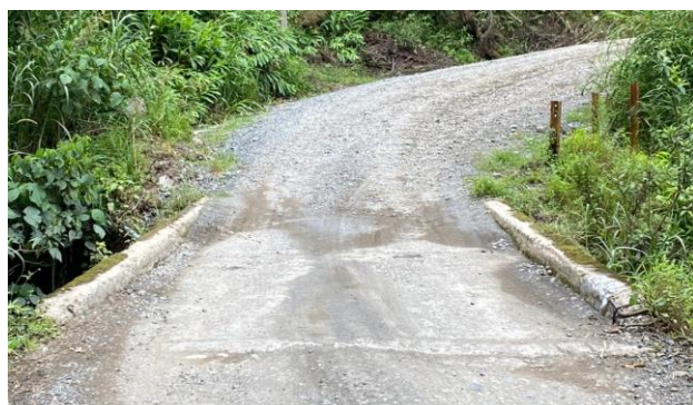
Figura A10. Ausencia de la baranda. Autoría propia.
