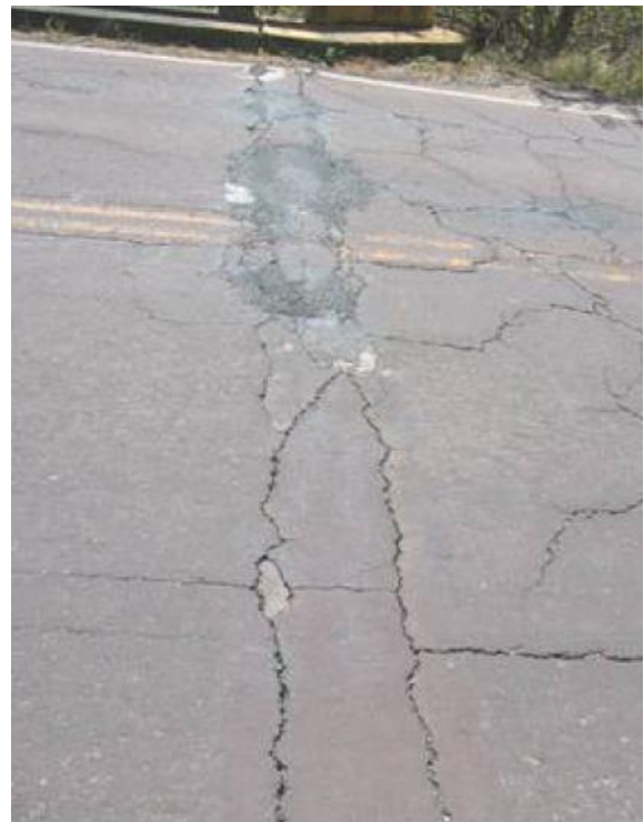
Figura 38. Sobrecapa de asfalto en la junta de expansión (MOPT, 2007).
