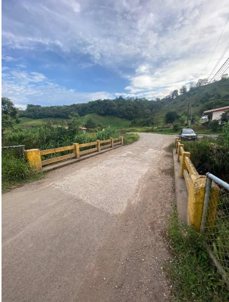
Figura A27. Obstrucción de las juntas de expansión. Autoría propia.
