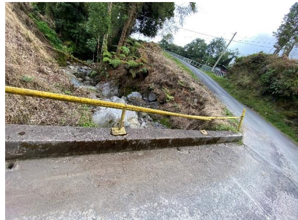
Figura A79. Daños en las barandas vehiculares. Autoría propia.
