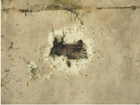
Figura 50. Cavidad en viga de concreto (MOPT, 2007).
