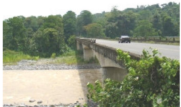
Figura 32. Faltante de una porción de la baranda de acero (MOPT, 2007).
