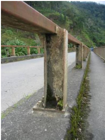
Figura 30. Oxidación en baranda de acero (MOPT, 2007).
