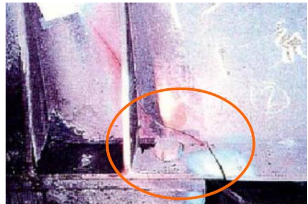
Figura 46. Grieta cerca del apoyo en viga principal de acero (MOPT, 2007).
