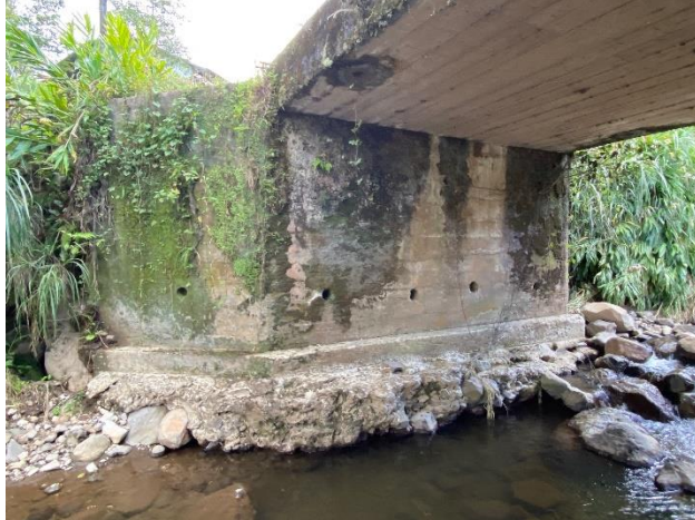
Figura A6. Socavación en el bastión B1. Autoría propia.
