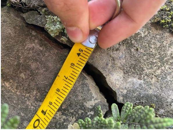
Figura 33. Agrietamiento de 1cm en baranda de concreto (Autoría propia, 2021).
