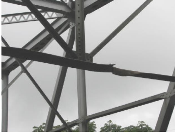
Figura 54. Rotura de elemento de acero en cercha (MOPT, 2007).
