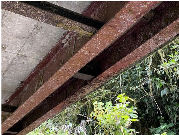
Figura A14. Oxidación y corrosión de las vigas principales. Autoría propia.
