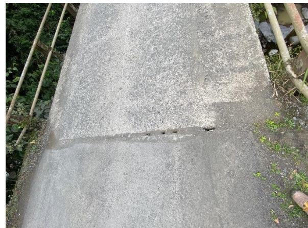
Figura A46. Obstrucción de la J1 de expansión. Autoría propia.
