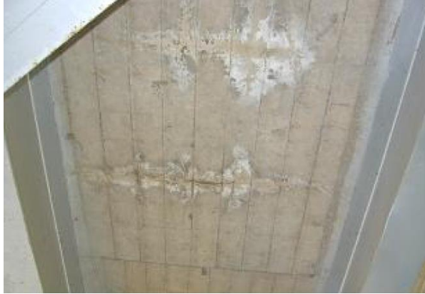
Figura 43. Eflorescencia en losa de concreto (MOPT, 2007).
