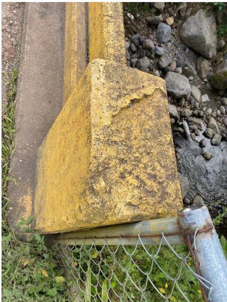
Figura A25. Daños en las barandas. Autoría propia.
