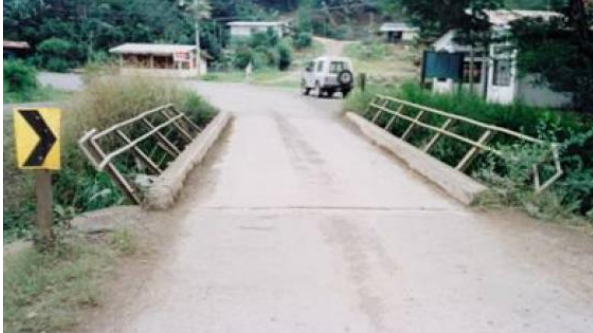
Figura 29. Deformación en barandas de acero (MOPT, 2007).
