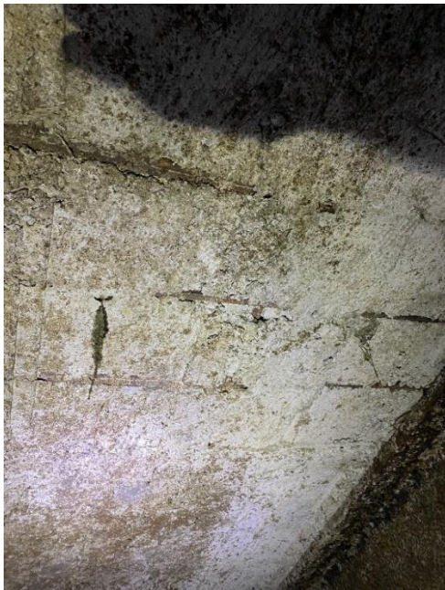
Figura A60. Acero de refuerzo expuesto en la parte inferior de la losa. Autoría propia.
