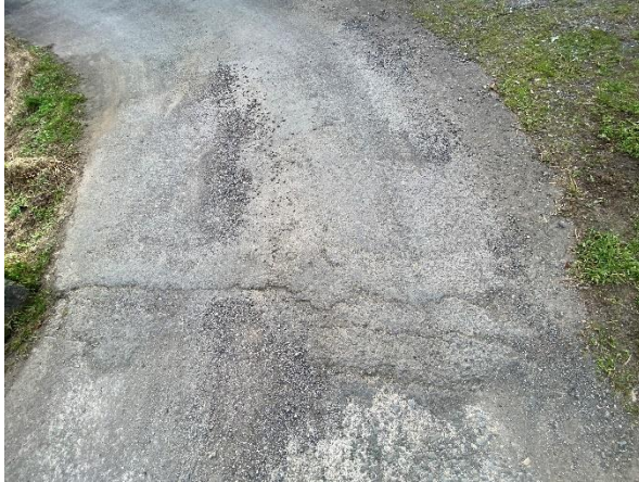
Figura A80. Obstrucción de las juntas de expansión. Autoría propia.
