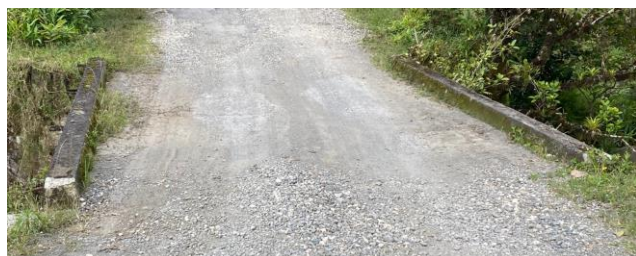
Figura A4. Obstrucción de las juntas de expansión. Autoría propia.
