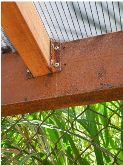
Figura 54: Oxidación en parabuses tipo P-03 Fuente: Municipalidad de Curridabat. (2021)
