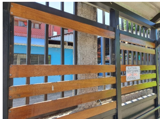
Figura 18: Madera faltante en el respaldo de asientos en una parabus.
