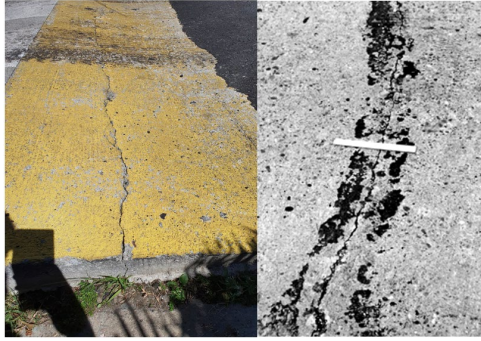
Figura 23: Comparación deterioros en sitio vs documento de fotos extraído ASTM D6433-20 Fuente: Elaboración propia.
