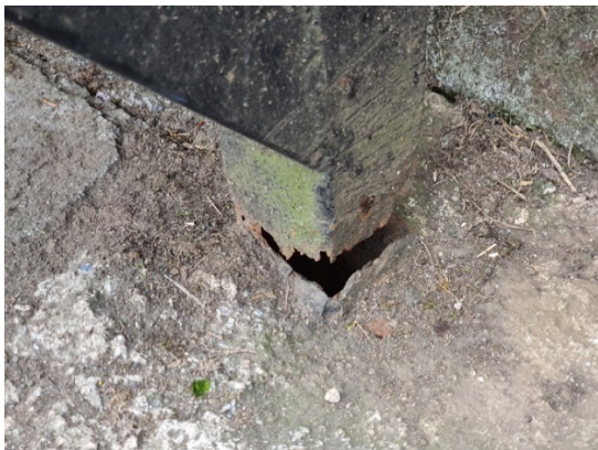
Figura 17: Columna oxidada de una parabus.
