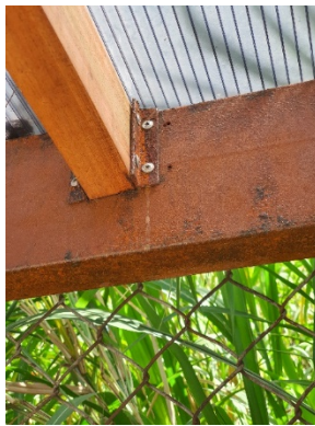
Figura 7: Oxidación en parabuses tipo P-03 Fuente: Elaboración Propia
