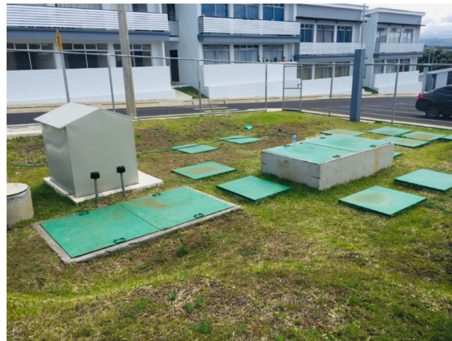
Imagen 88. Planta de tratamiento. Grupo MT.
