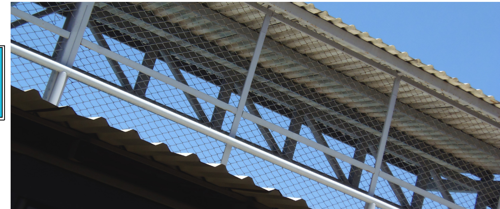
En esta página, arriba: Imagen 7.15. Detalle de elementos constructivos y materiales empleados en las graderías y que se encuentran en otros de los espacios de la piscina. Fuente: Colección personal.
