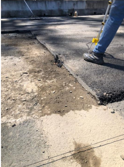
Figura 34. Daños en las juntas transversales
