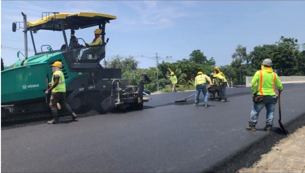
Figura 37. Extensión del asfalto en juntas longitudinales
