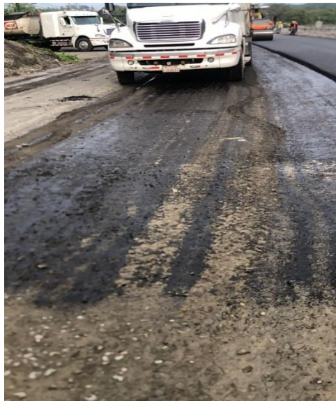
Figura 31. Desprendimiento del riego de liga
