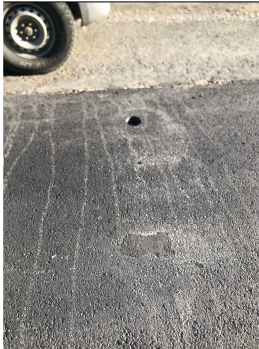
Figura 36. Núcleos sin rellenar
