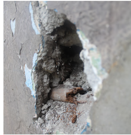
30 Canto del revoque de concreto
