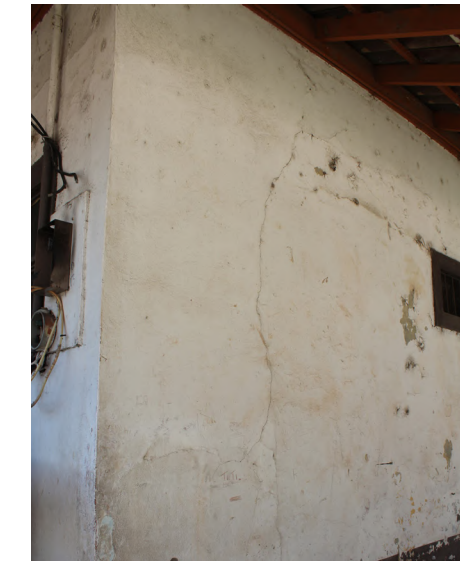
47 Grieta en pared c
