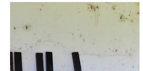
40 Grieta en pared d
