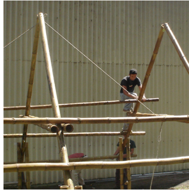
Figura 14. Tensores en el Miravalles
