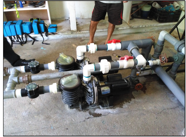
Fig. 16 Equipo de bombeo
