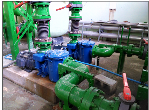
Fig. 30 Equipo de bombeo de piscina olímpica
