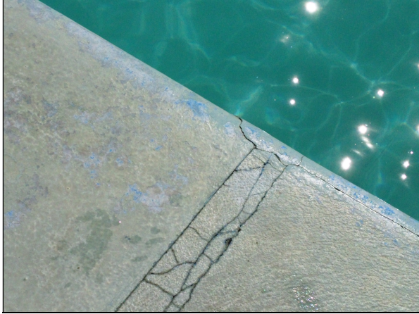
Fig. 12 Grieta formada desde la superficie y que se extiende hasta el otro extremo de la piscina.
