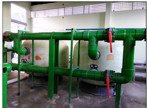
Fig. 31 Equipo de filtración de piscina olímpica
