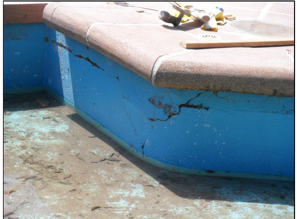
Fig. Agrietamiento de una piscina
