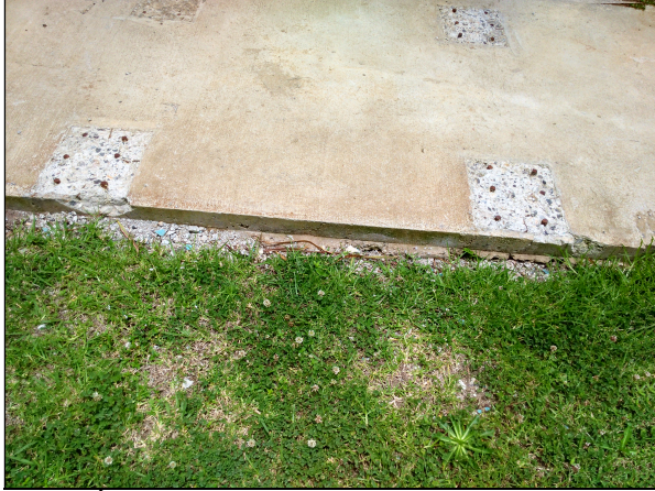
Fig. 26 Área verde aledaña a la piscina que ha sufrido asentamiento debido a la fuga que estaba de ese mismo lado.
