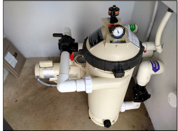
Fig. 59 Equipo de bombeo y filtración.
