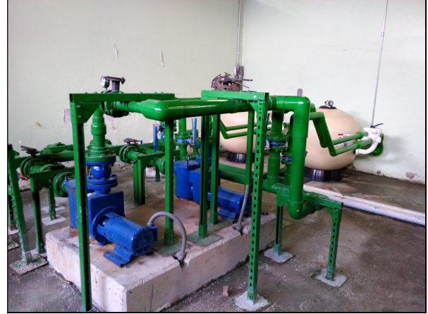
Fig. 29 Equipos de bombeo y filtración de piscina pedagógica
