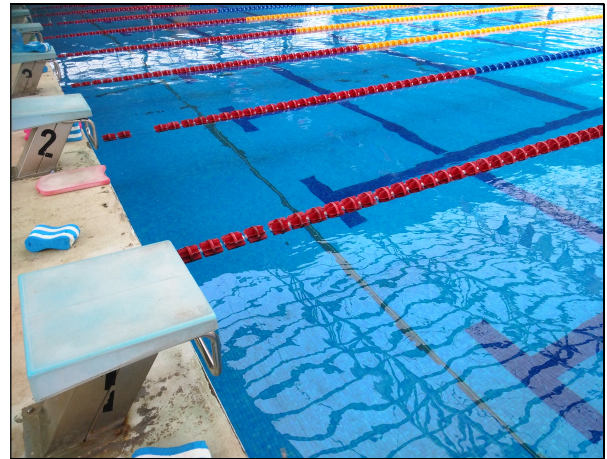
Fig. 24 Junta de construcción desde otro ángulo
