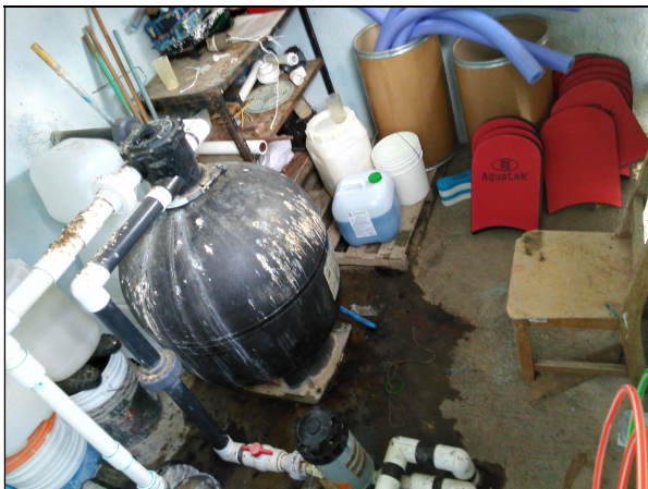
Fig. 46 Equipo de bombeo y filtración
