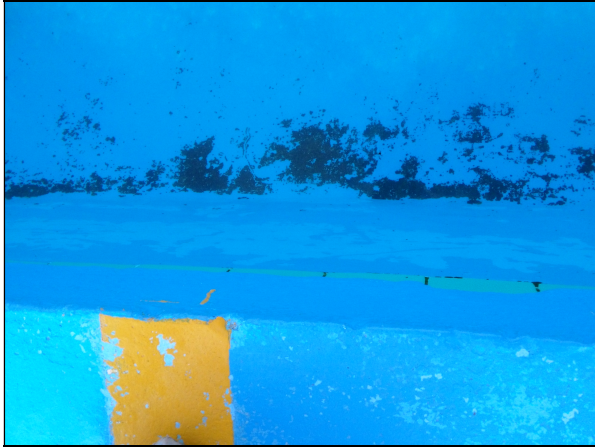
Fig. 44 Vista del fondo de la piscina, pintura dañada
