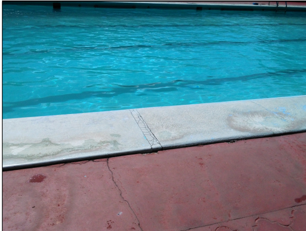
Fig. 13 Grietas vista desde la superficie
