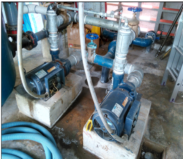
Fig. 49 Equipos de bombeo
