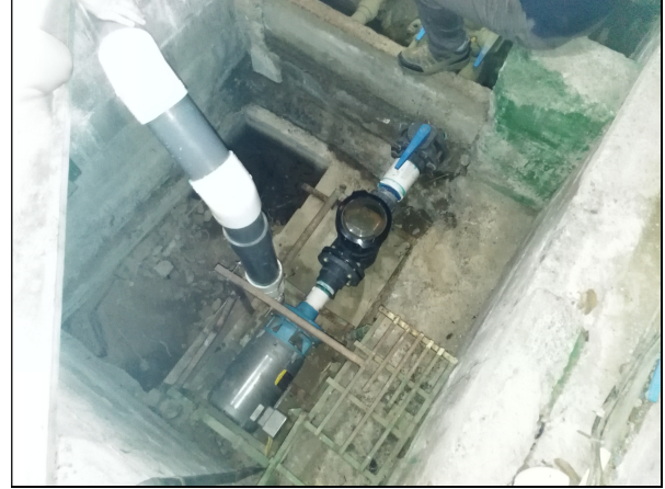
Fig. 35 Equipo de bombeo de la piscina
