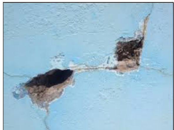
Fig. 11 Agrietamiento en la pared de una piscina
