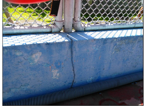
Fig. 15 Grieta que recorre desde la superficie hasta el extremo opuesto de la piscina
