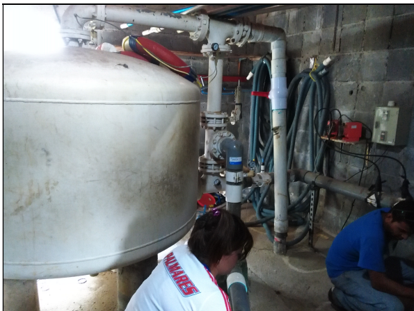
Fig. 34 Sistema de filtración de la piscina
