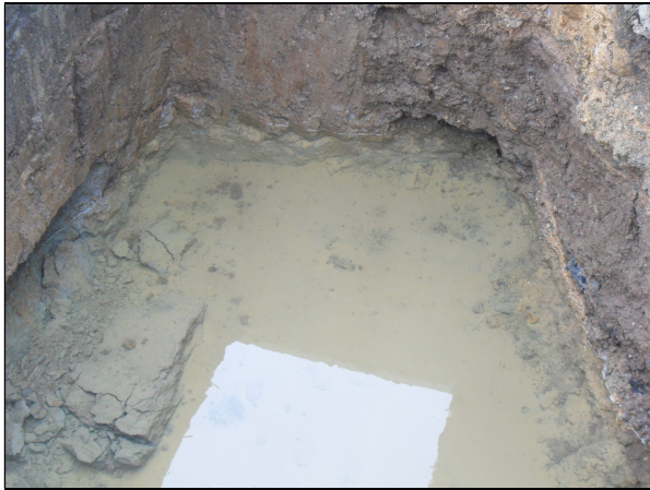
Fig. 27 Momento en que se inició la construcción de las placas de fundación y se evidenció el problema del agua
