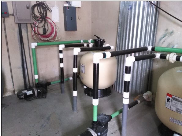
Fig. 38 Cuarto de máquinas donde se encuentra los equipos de bombeo y filtración.
