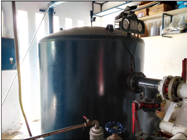
Fig. 48 Filtro de arena y grava.
