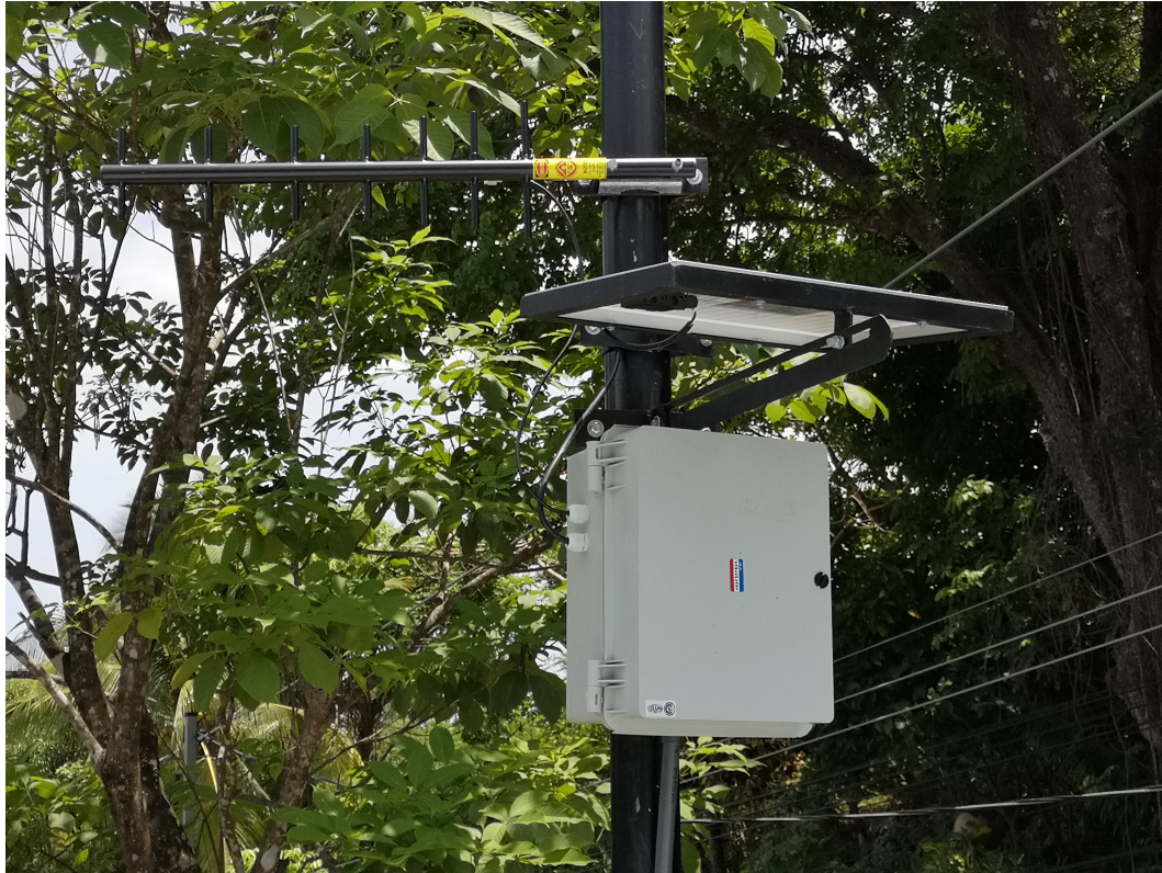
Figura 6.18: Gabinete IP65, panel solar y antena Yagi instalada en el tanque principal. Fuente: Elaboración propia.
