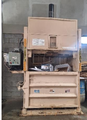
Figura 4.55: Compactadora del CRRV de Oreamuno.
