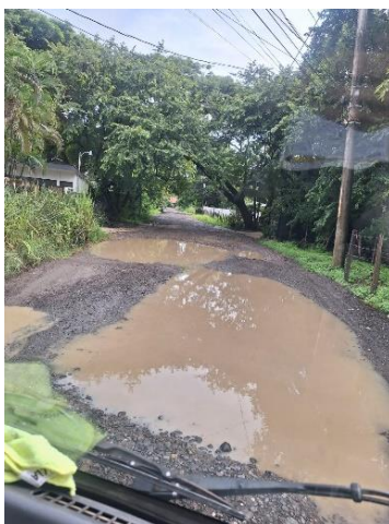
Figura 4.9: Calle de Nosara en mal estado durante la época lluviosa.
