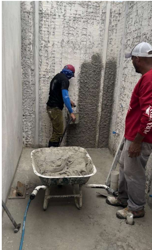
Figura 28. Fotografía de repello de paredes de covintec usando compresor para Work Sampling.
