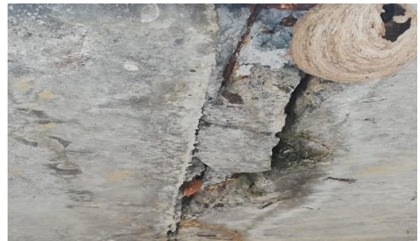
Figura 52: Las losas prefabricadas presentan daños en las juntas, existen desprendimiento del concreto y el acero está expuesto.
