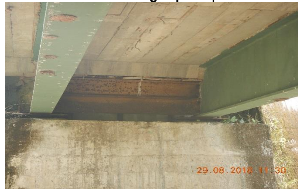
Figura 66: La exposición al ambiente y condiciones de la zona han generado oxidación en múltiples elementos metálicos del puente.
