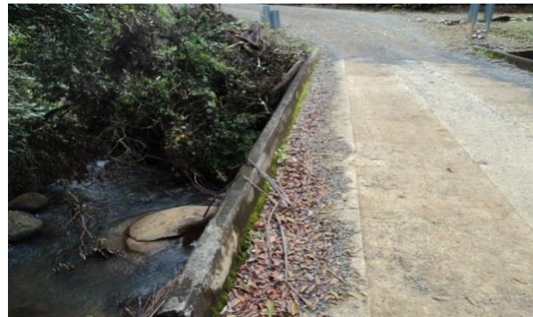
Figura 82: No hay barandas, ni sistemas de canalización en el puente.
