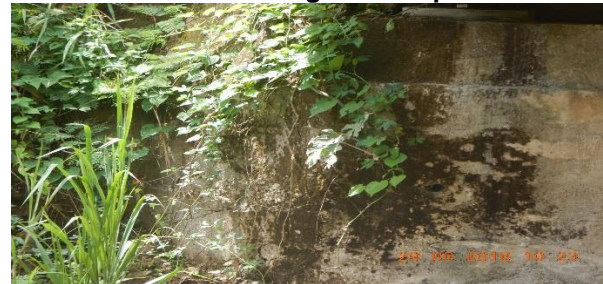
Figura 61: La Viga Cabezal presenta indicios de eflorescencia
