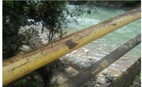
Figura 41: Las barandas presentan daños menores y desprendimientos localizados de pintura.
