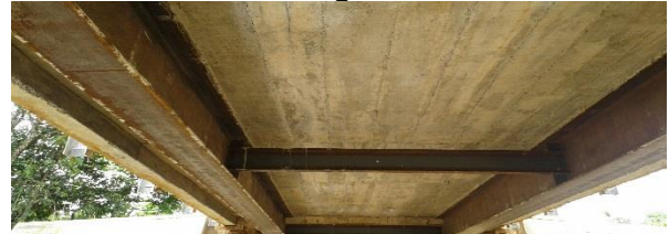
Figura 79: Las vigas en este puente fueron colocadas sin aplicarles previamente un sistema de protección.
