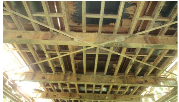
Figura 46: Los elementos del tablero muestran oxidación localizada y crecimiento de vegetación.
