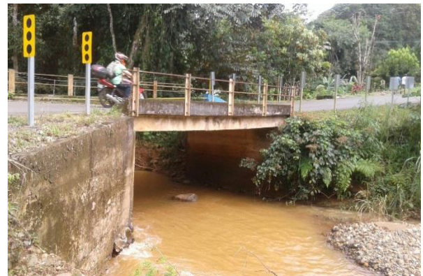
Figura 76: La losa muestra una deflexión notable hacia el centro.
