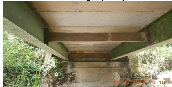
Figura 62: La exposición al ambiente y condiciones de la zona han generado oxidación en múltiples elementos metálicos del puente.
