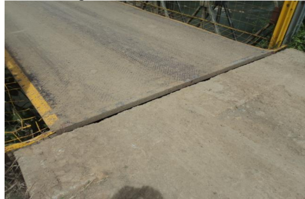
Figura 87: Se identificó un inicio de desgaste en las láminas del puente que funcionan como superficie de ruedo.
