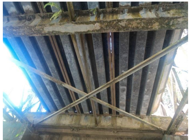
Figura 93: Los elementos del tablero muestran oxidación localizada y crecimiento de vegetación.
