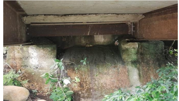
Figura 51: Los bastiones presentan principios de eflorescencia.
