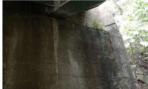
Figura 57: La viga cabezal presenta indicios de eflorescencia
