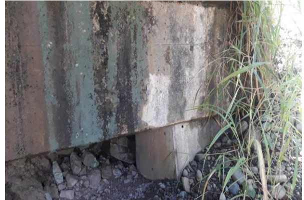
Figura 35: Parte del material cercano a la cimentación se ha desplazado.
