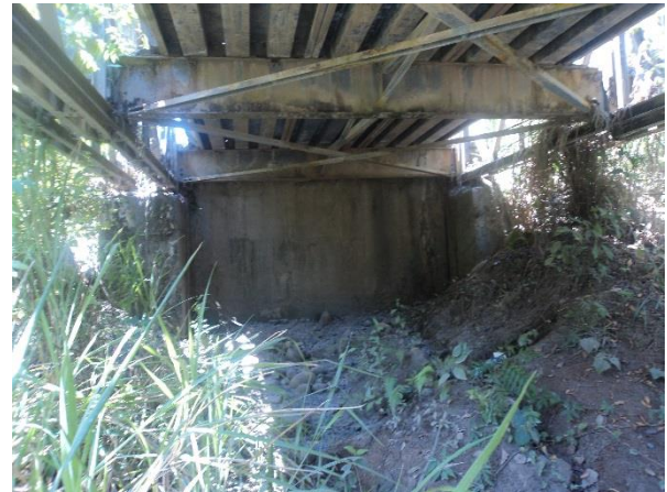
Figura 24: Parte del material cercano a la cimentación se ha desplazado.
