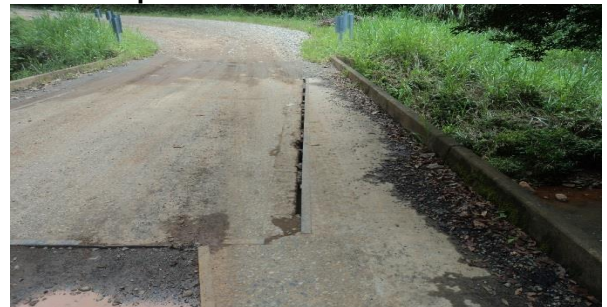
Figura 70: En el puente existe una separación en la superestructura producto de una ampliación del puente.
