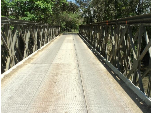
Figura 94: Existe un desgaste de la superficie de ruedo, especialmente en las huellas vehiculares.
