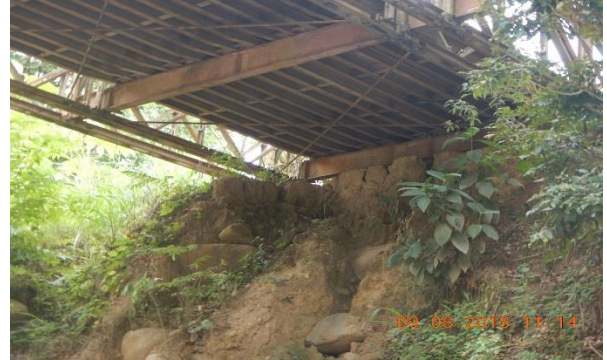
Figura 29: Parte del material cercano a la cimentación se ha desplazado.
