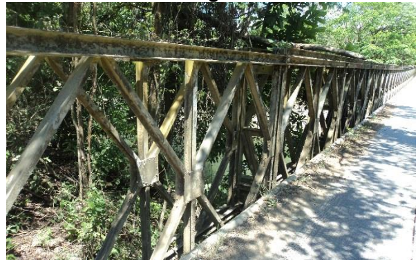
Figura 92: Las vigas laterales muestran oxidación y acumulación de vegetación.
