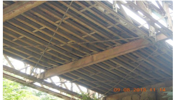
Figura 30: La exposición al ambiente y condiciones de la zona han generado oxidación en múltiples elementos metálicos del puente.
