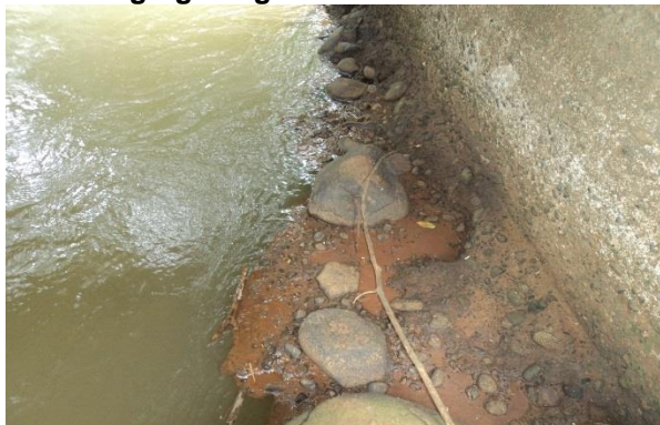
Figura 72: Hay socavación que se extiende por debajo de las fundaciones del puente.
