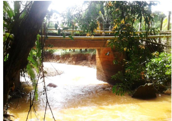
Figura 75: Hay socavación que se extiende por debajo de las fundaciones del puente.
