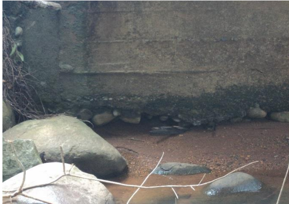
Figura 84: El material cercano al bastión se ha comenzado a erosionar.
