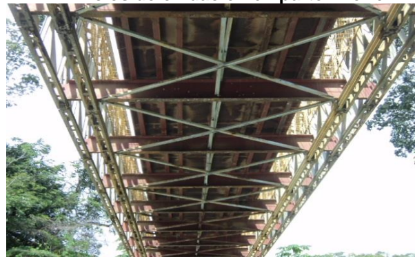
Figura 88: Existen focos de oxidación en algunos elementos del puente, especialmente en los elementos de arrioste lateral.
