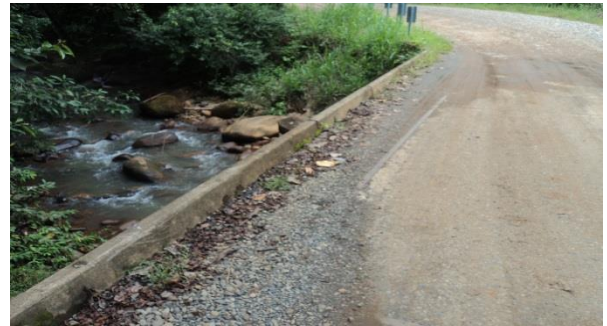
Figura 69: No hay barandas ni sistemas de canalización en el puente.
