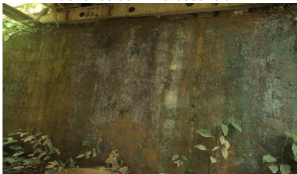
Figura 48: La Viga Cabezal presenta indicios de eflorescencia
