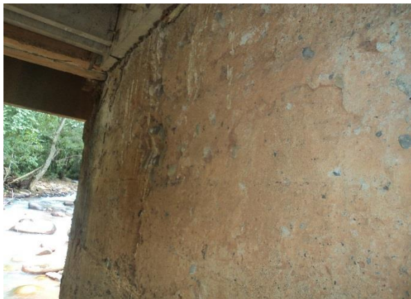
Figura 71: El concreto de los bastiones presenta deficiencias superficiales.
