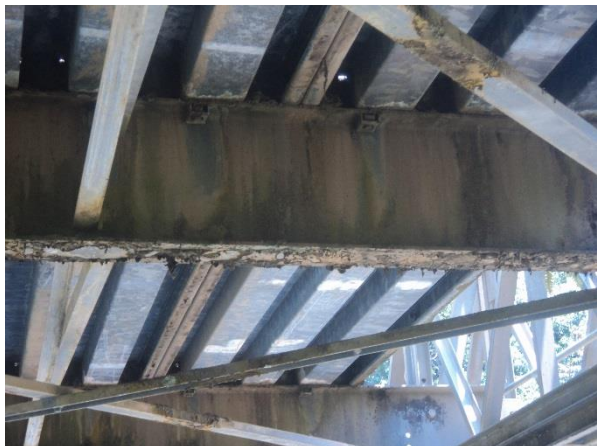
Figura: 25: La exposición al ambiente y condiciones de la zona han generado oxidación en múltiples elementos metálicos del puente.
