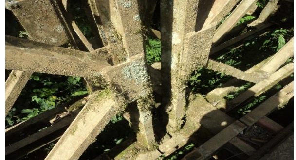
Figura 45: Las vigas laterales muestran oxidación y acumulación de vegetación.
