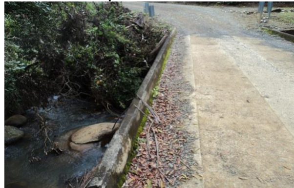
Figura 83: Se identifica un bordillo fracturado.
