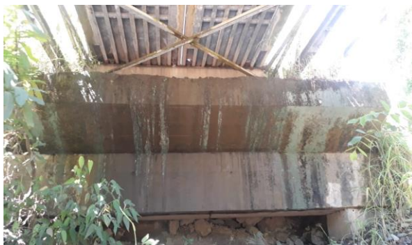
Figura 38: La Viga Cabezal presenta indicios de eflorescencia
