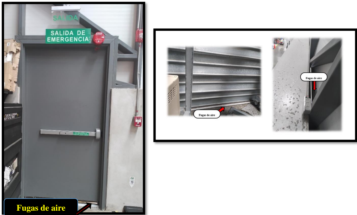
Figura 80. Fugas de aire en puertas de salida de emergencia y cortinas metálicas del área de moldeo
