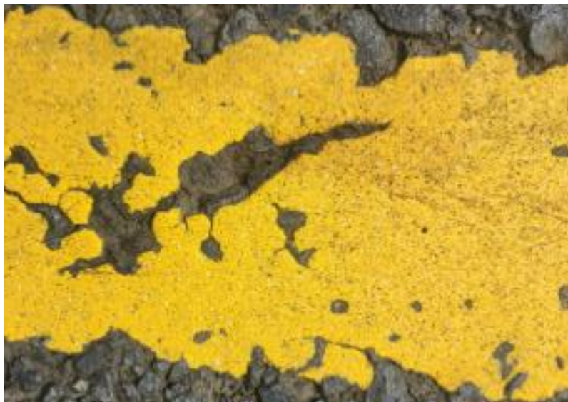
Figura 136 Material termoplástico desprendido en puntos donde quedo vacío.
