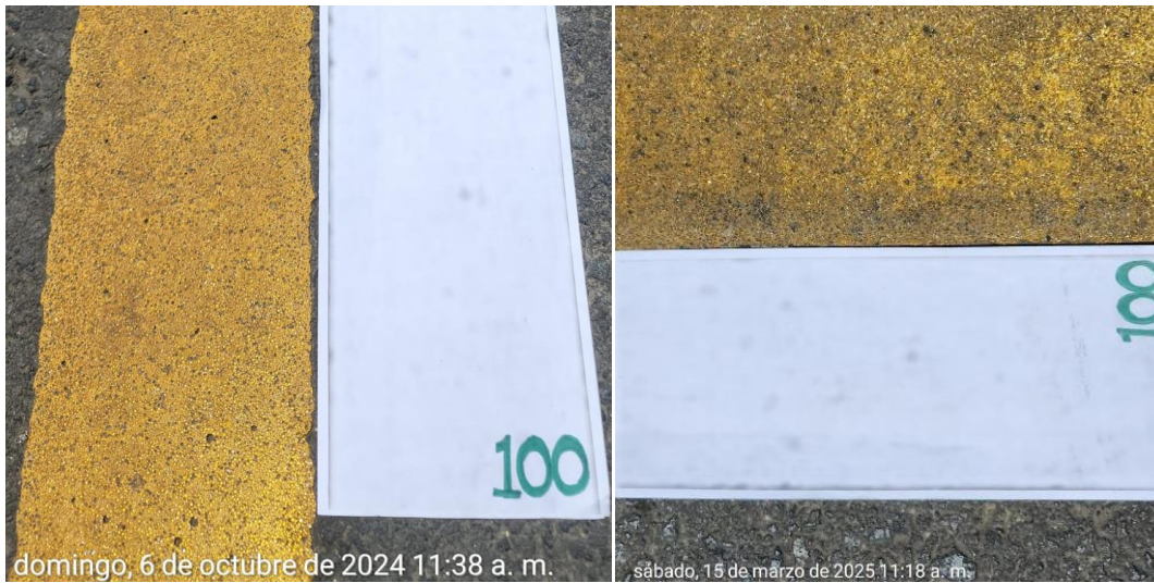
Figura 129 Desprendimiento material termoplástico, el día 6/10/2024
