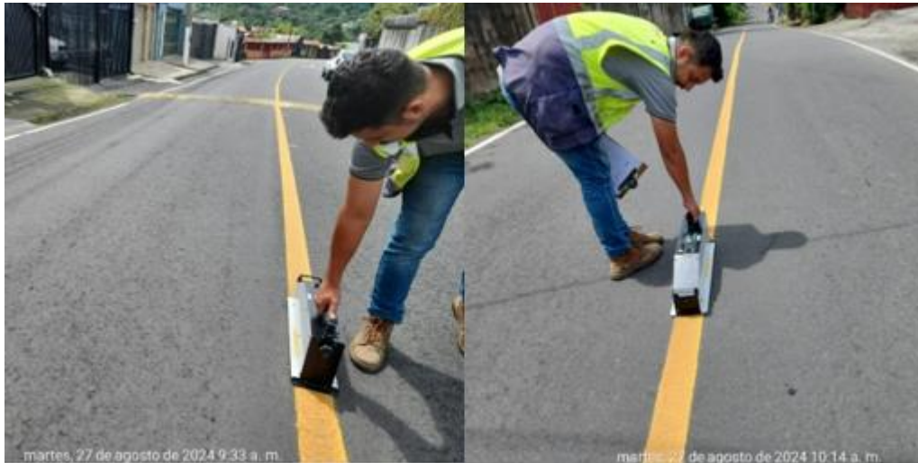
Figura 28 Medición de retroreflectividad del 27 de agosto del 2024, en paños de prueba varios
