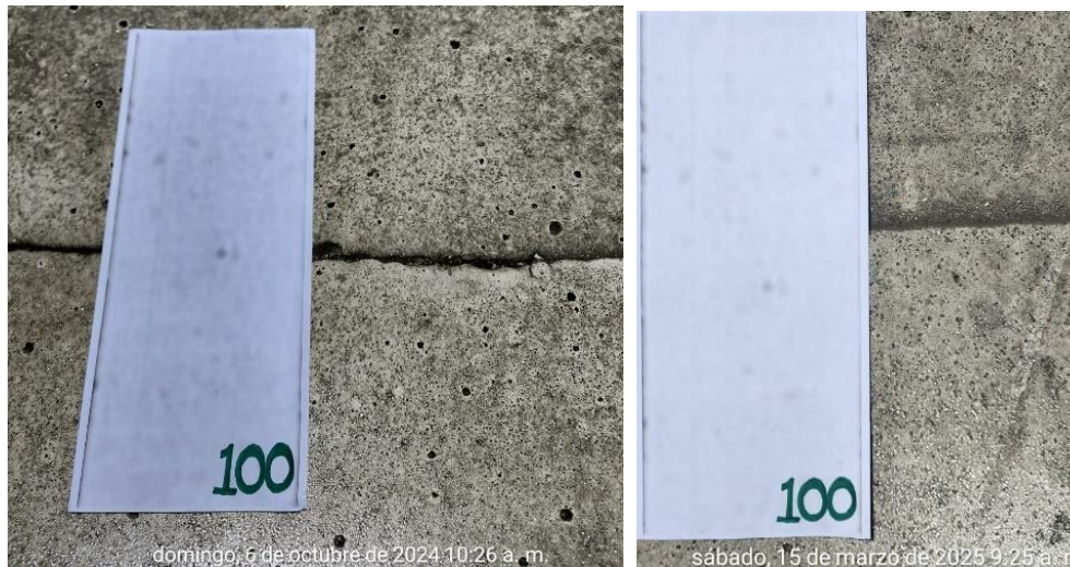
Figura 86 Desprendimiento material termoplástico, el día 6/10/2024
