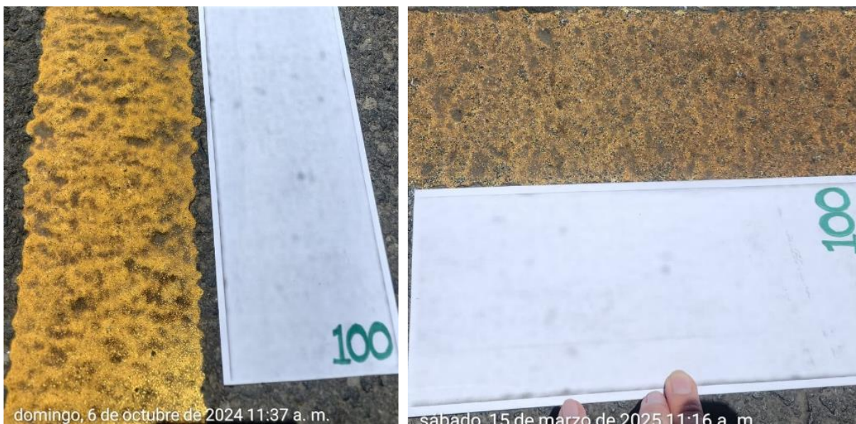
Figura 125 Desprendimiento pintura plástico en frío, el día 6/10/2024
