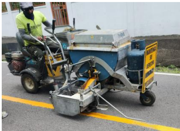
Figura 21 Equipo de demarcación para material termoplástico
