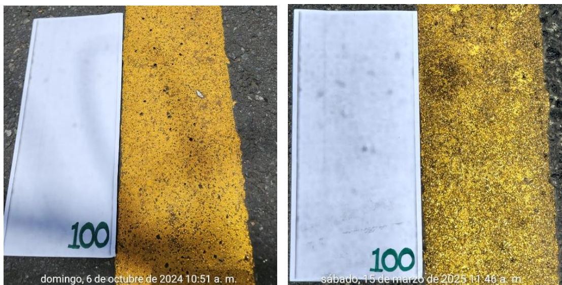
Figura 73 Desprendimiento material termoplástico, el día 6/10/2024
