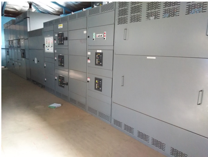
Figura 19. Celda de medición existente del Hospital.
