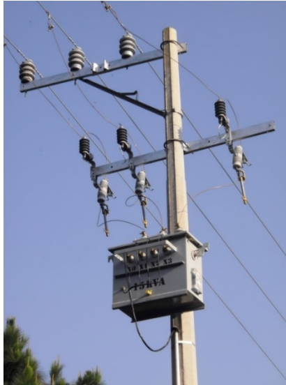
Figura 6. Transformador Trifásico Tipo Poste.
