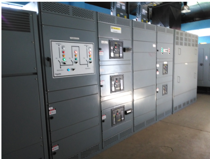
Figura 13. Cuarto Eléctrico con celda MT.
