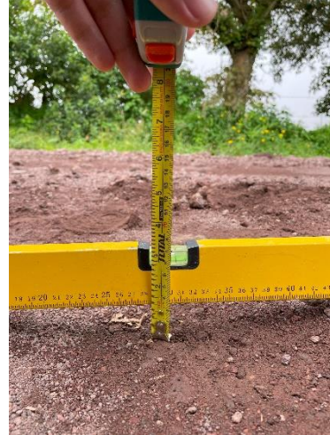
Figura 39. Profundidad bache 2 UM-02 Jaules 18/10
