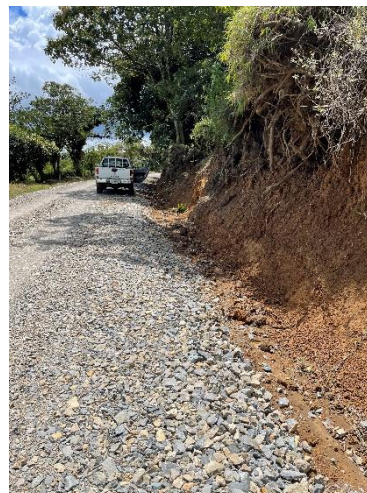
Figura 33. Drenaje izquierdo UM-02 El Cerro 04/10
