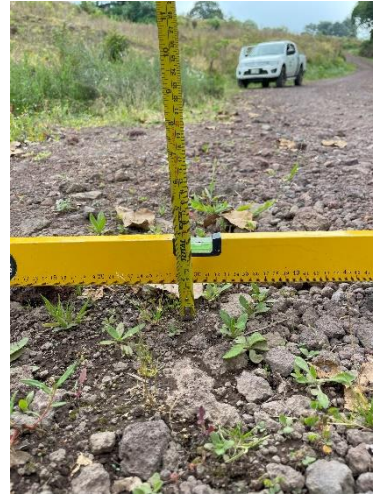
Figura 27. Profundidad bache 1 UM-02 Jaules 04/10
