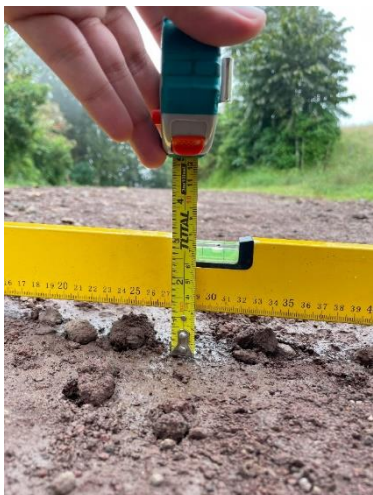
Figura 83. Profundidad bache 3 UM-02 Jaules 15/11
