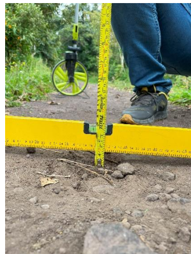
Figura 29. Profundidad bache 1 UM-01 Jaules 04/10
