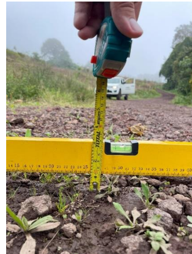
Figura 83. Profundidad bache 2 UM-02 Jaules 15/11
