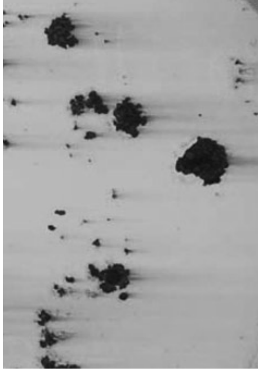
(b) Corrosión en pintura causada por discontinuidades en la película
