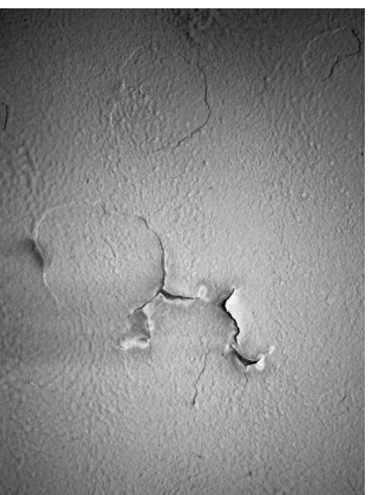
(b) Corrosión causada por falta de adhesión
