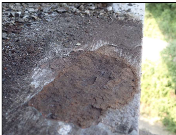
Figura 50. Foco de corrosión cerca del pilar P02.
