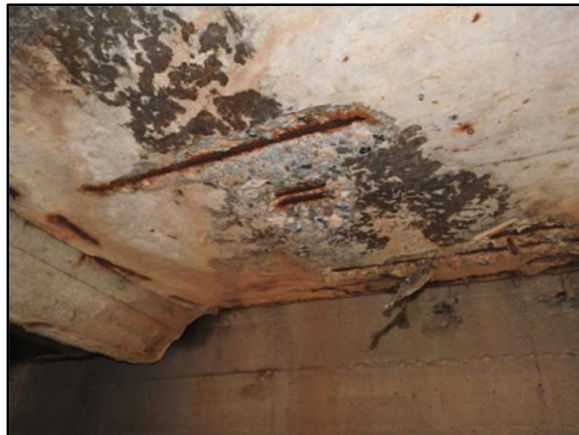
Figura 55. Armadura de la losa expuesta a la corrosión
