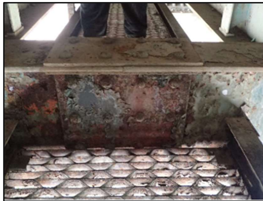
Figura 52. Corrosión pítica en viga transversal.
