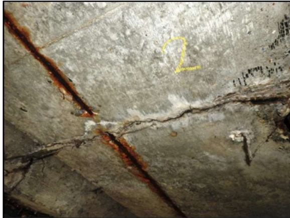
Figura 54. Fisura desde la vista inferior de la losa de concreto reforzado.
