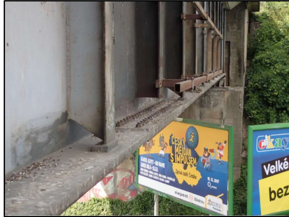
Figura 48. Detalle de los refuerzos verticales.
