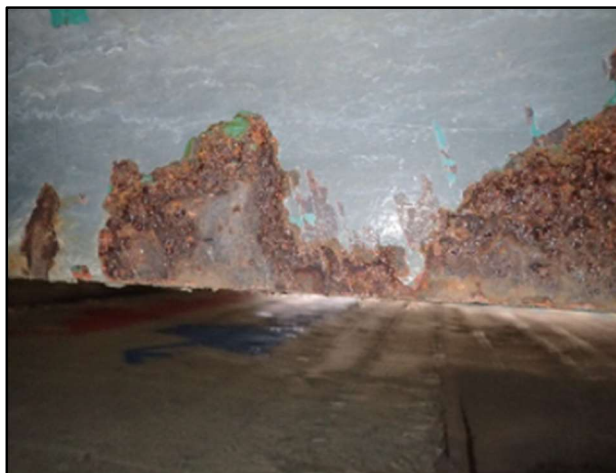
Figura 49. Corrosión local en el extremo de la viga principal, cerca del apoyo O02 debido al agua que gotea.
