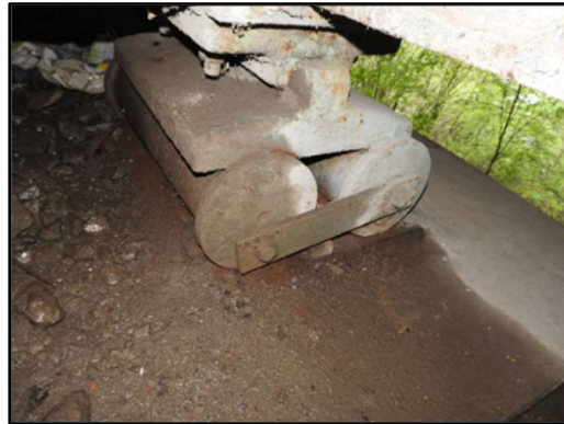
Figura 53. Tornillo de acoplamiento faltante en apoyo O02.
