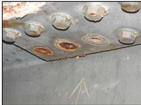
Figura 56. Tornillos faltantes en unión de la viga principal izquierda.
