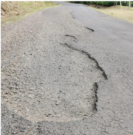
Fotografía muestra el estado de la calzada a intervenir:2021-2022
