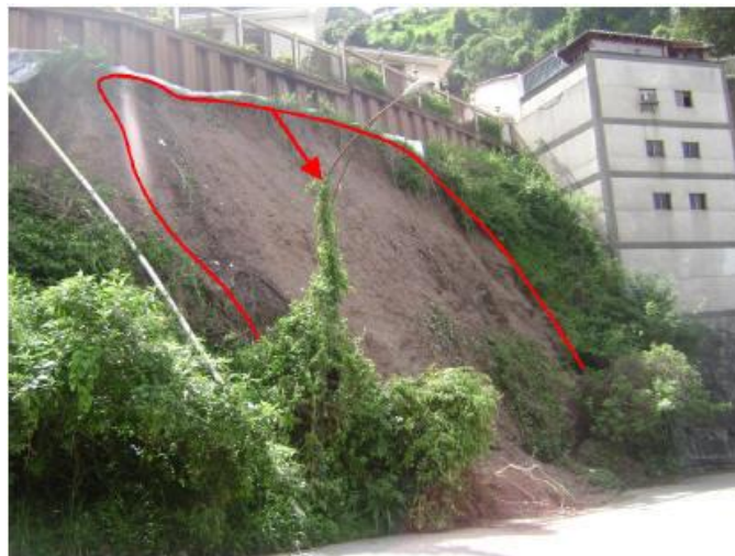
Figura 14. Falla superficial ocurrida en las rutas inter colinas de Santa Mónica, Venezuela.
