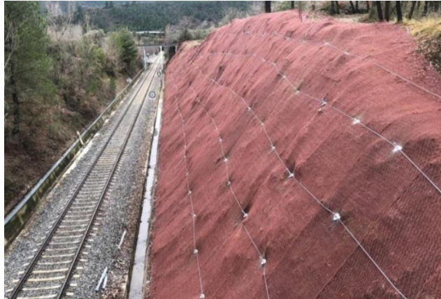
Figura 5. Implementación de malla para la estabilidad de talud sobre vía ferroviaria en Canadá.
