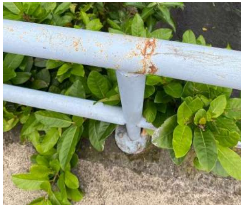
Figura 110. Inicio de oxidación en barandas de acero.
