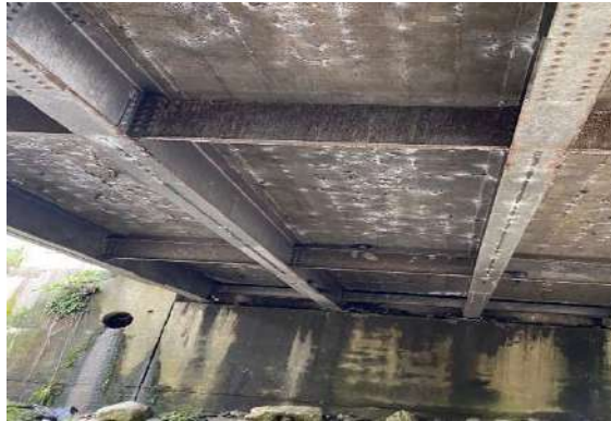
Figura 146. Oxidación en vigas principales de acero.
