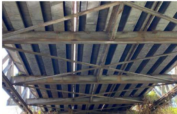
Figura 97. Oxidación en sistema de arriostramiento y vigas principales de acero.
