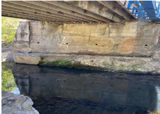
Figura 104. Grieta profunda en aletón del bastión.
