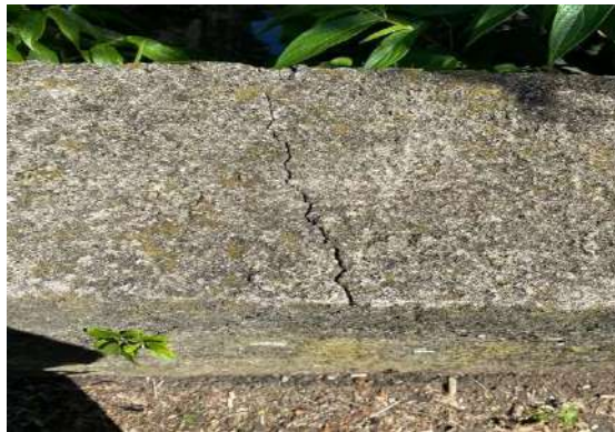
Figura 83. Agrietamiento en la baranda de concreto.
