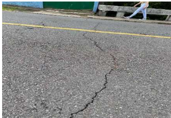
Figura 145. Grietas de gran grosor en superficie de rodamiento.
