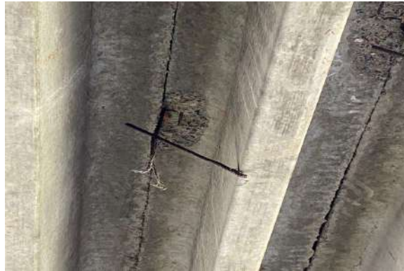
Figura 138. Nidos de piedra y eflorescencia en vigas principales de concreto.
