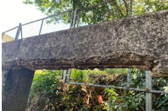
Figura 160. Acero de refuerzo expuesto y reducción en la sección de la baranda de concreto.
