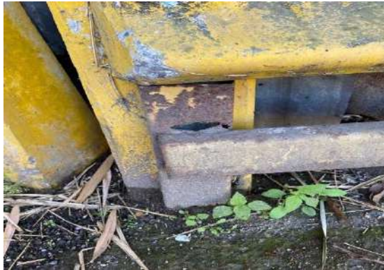
Figura 78. Oxidación y corrosión en baranda de acero.
