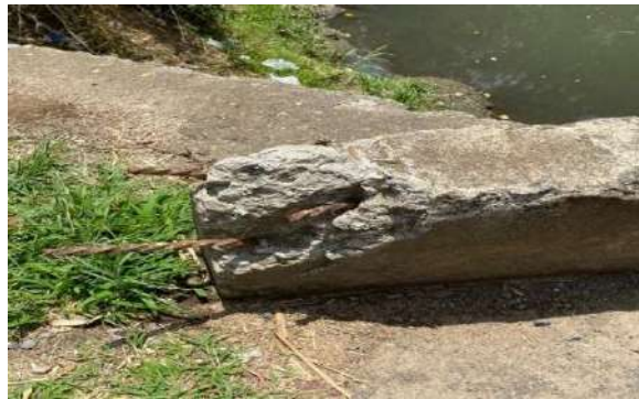
Figura 126. Acero de refuerzo expuesto y reducción en la sección.
