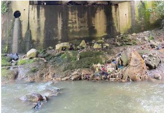
Figura 147. Socavación en cuerpo principal del bastión.
