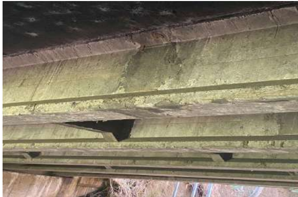
Figura 161. Eflorescencia y descascaramiento en vigas principales de concreto.
