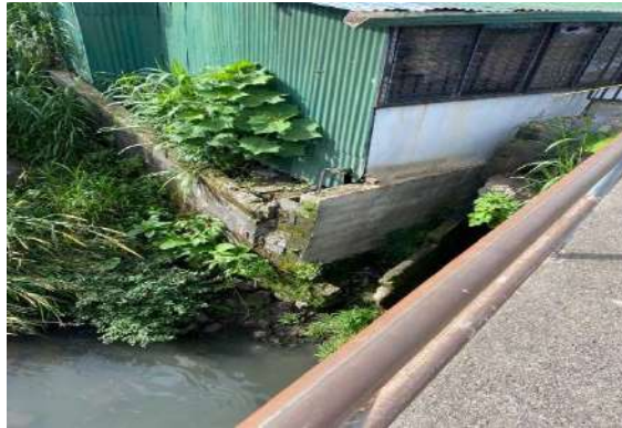
Figura 71. Vivienda en riesgo de desplazarse hacia el río.
