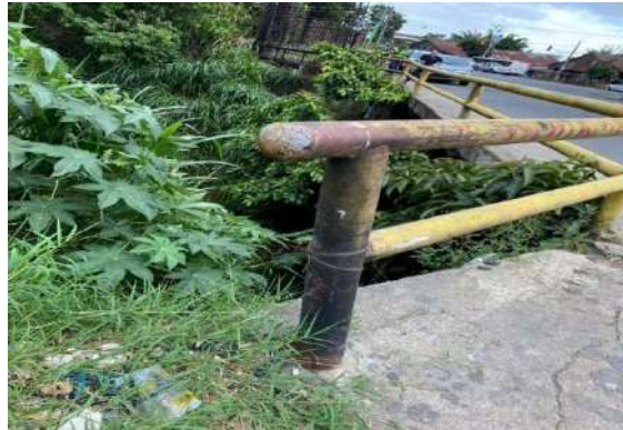
Figura 133. Hollín y oxidación en baranda de acero.
