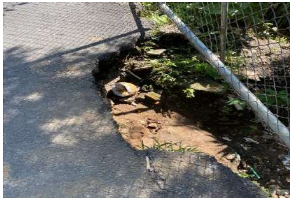
Figura 84. Deslizamiento en cercanías del puente.
