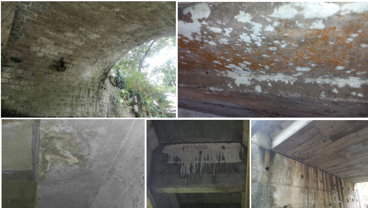
Figura 30. Eflorescencia en diferentes elementos de concreto.
