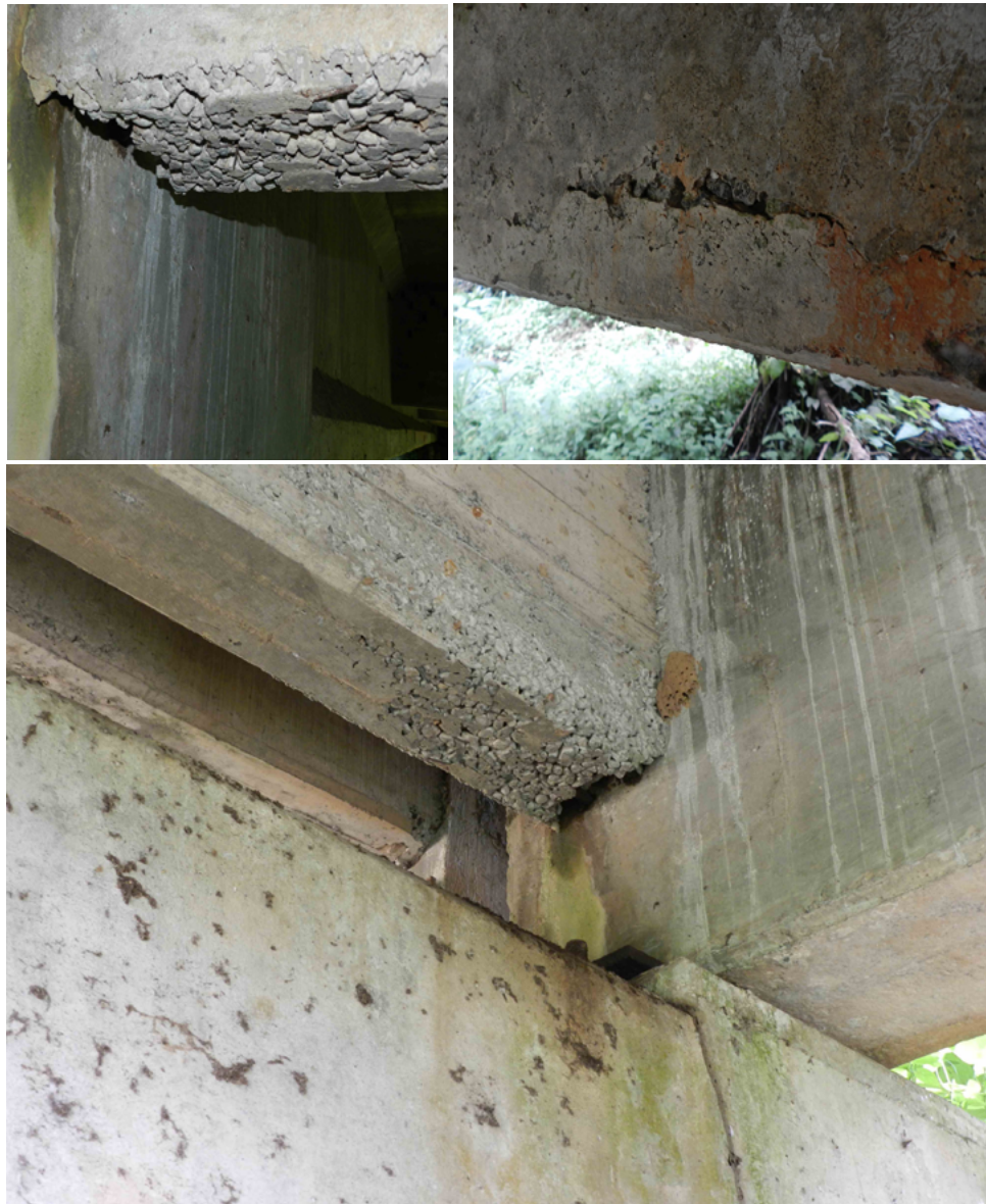
Figura 34. Nidos de piedra en el concreto.
