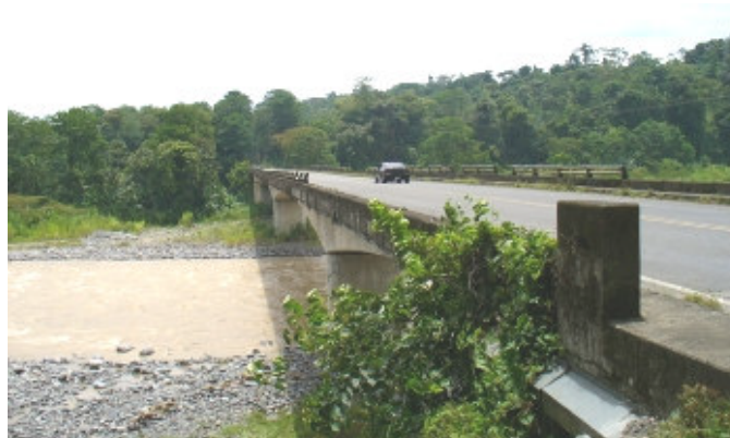
Figura 99. Faltante de baranda de concreto.
