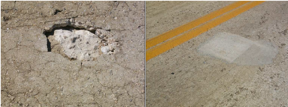
Figura 51. Daño antes y después de la reparación.
