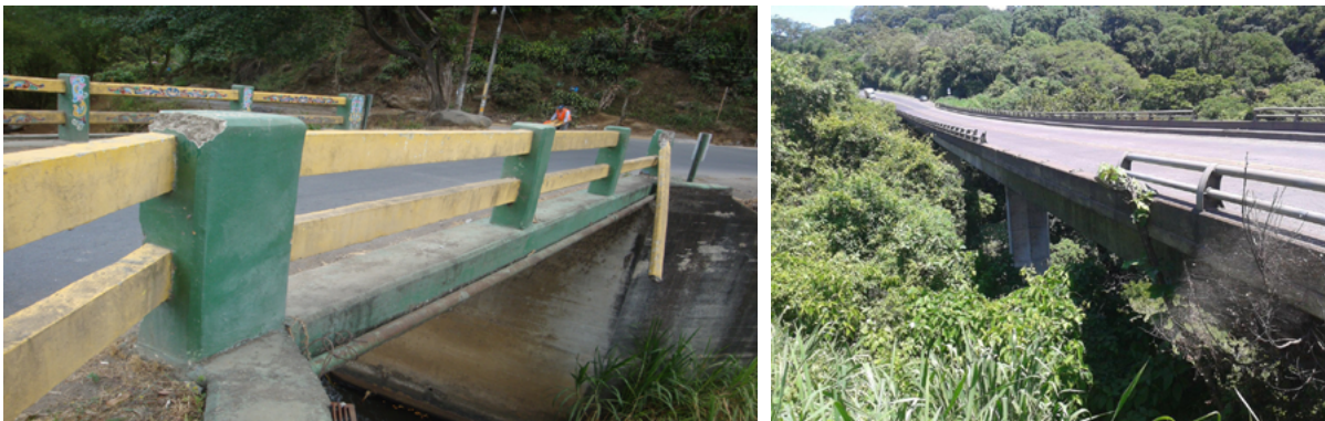
Figura 100. Faltante de baranda de concreto.
