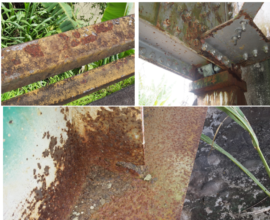
Figura 70. Corrosión en elementos de acero.
