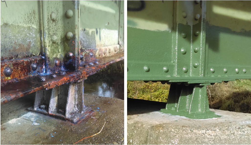
Figura 110. Daño antes y después de la reparación de la pintura. Fuente: Federal Highway Administration (2018).
