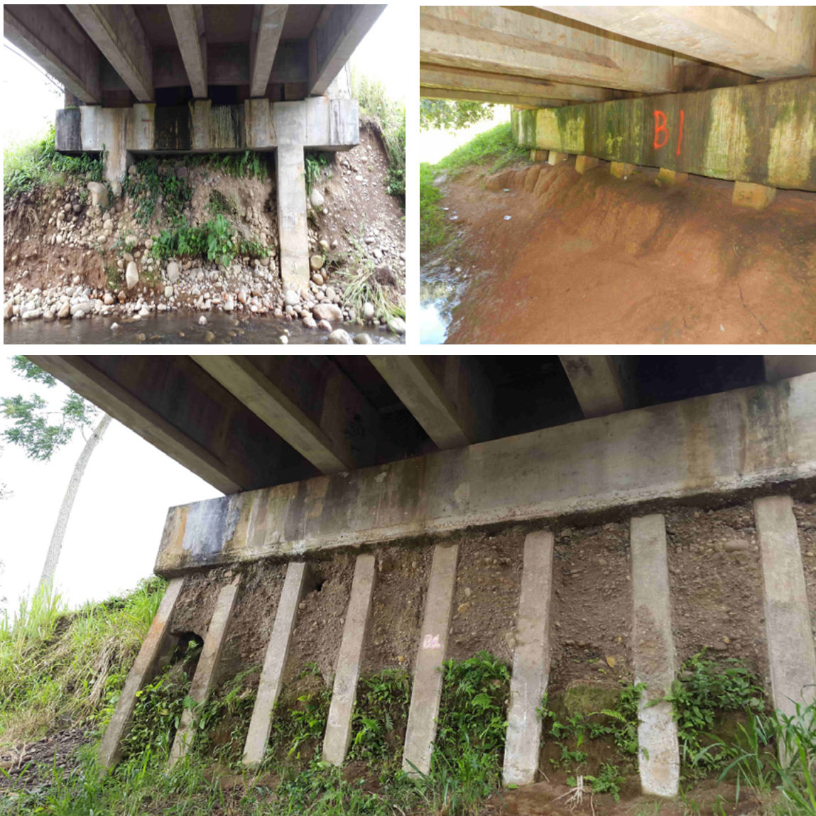
Figura 93. Socavación en bastiones. Fuente: PEEP (2018).
