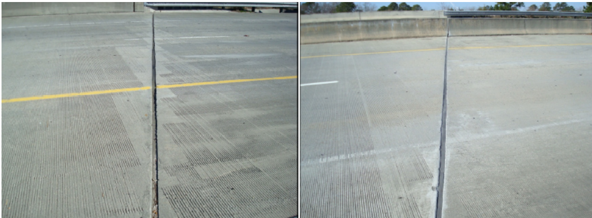
Figura 79. Daño antes y después de la reparación.
