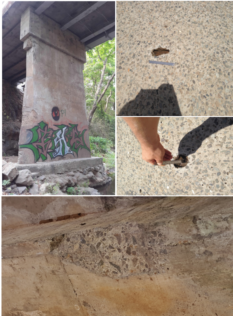
Figura 45. Descascaramiento del concreto.
