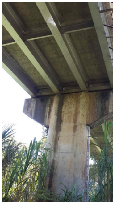
Figura 74. Filtración de agua en juntas. Fuente: PEEP (2018).
