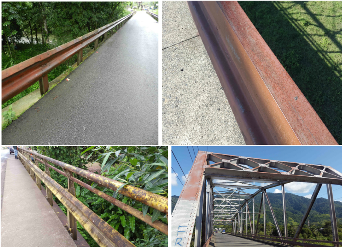
Figura 72. Oxidación en elementos de acero.
