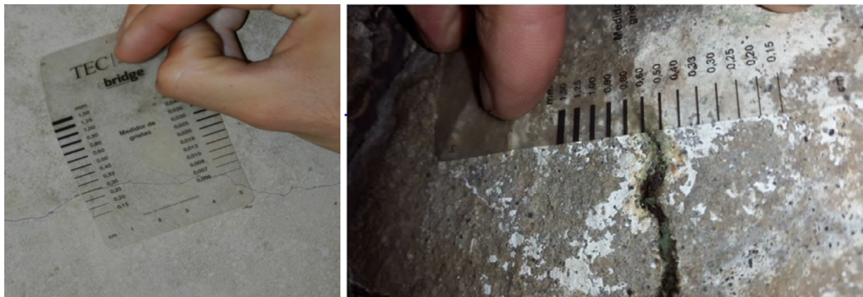
Figura 80. Grietas en una dirección.
