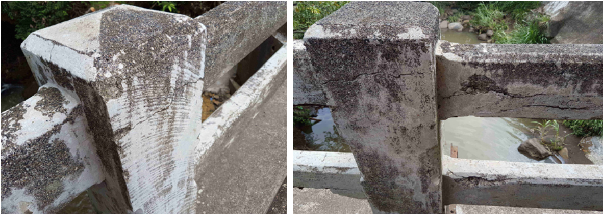
Figura 108. Agrietamiento en barandas de concreto. Fuente: PEEP (2018).
