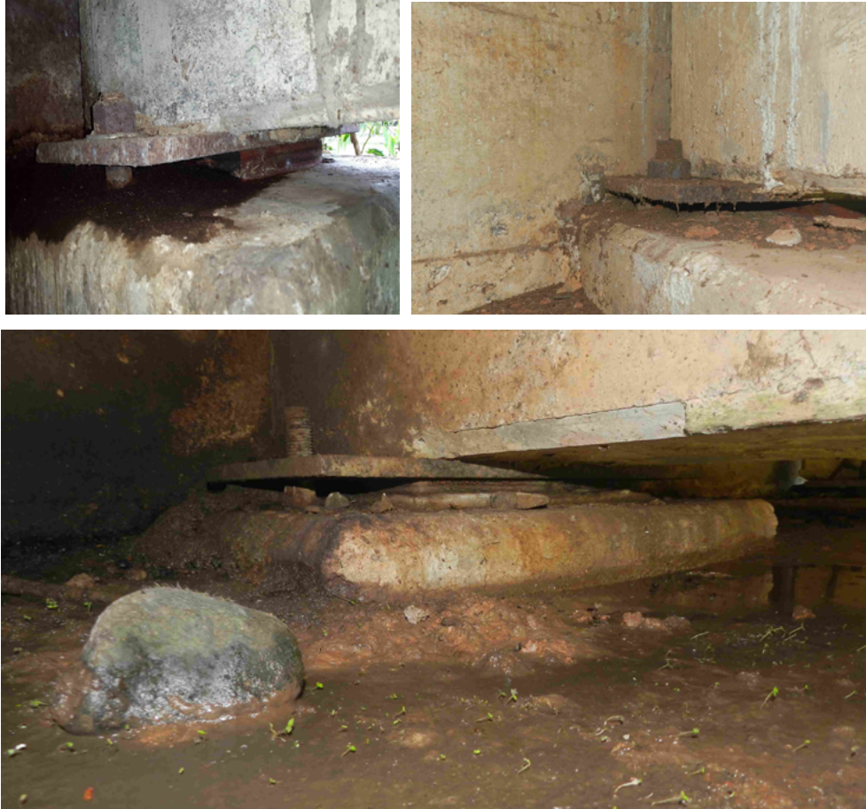
Figura 112. Apoyos deteriorados. Fuente: PEEP (2018).
