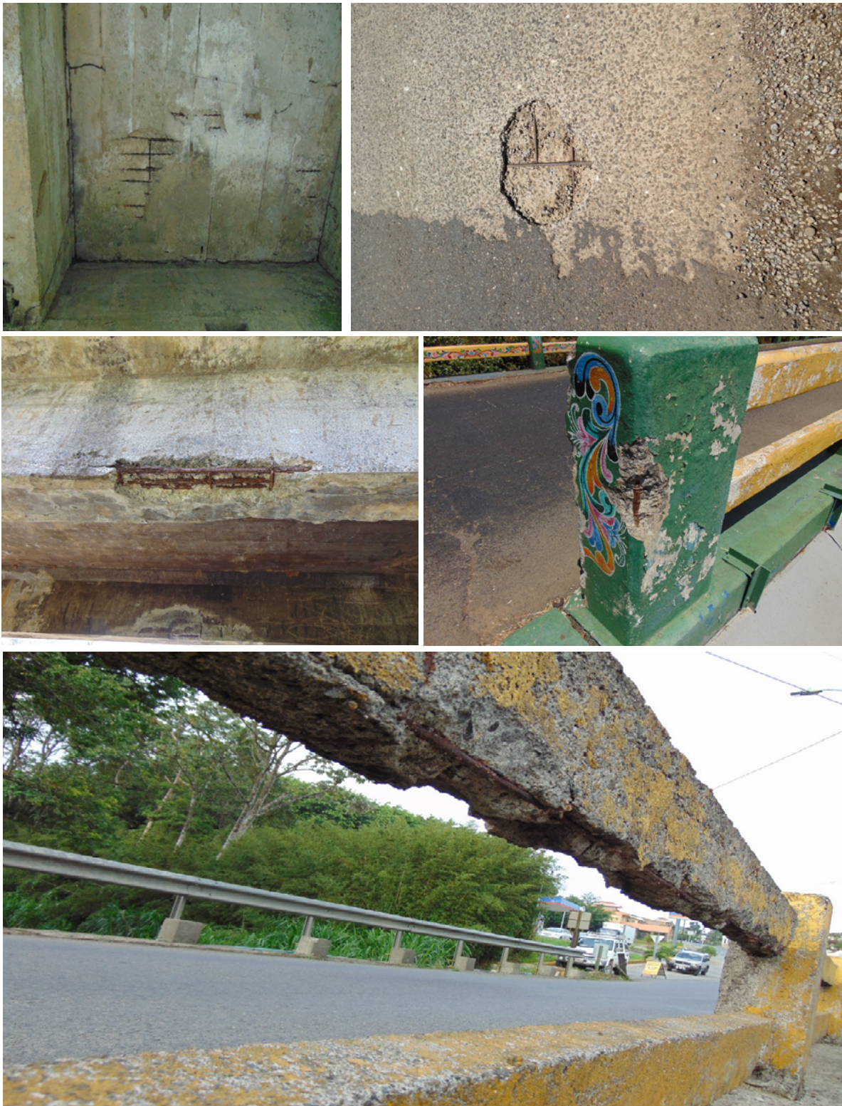
Figura 3. Acero expuesto en diferentes elementos de concreto. Fuente: PEEP (2018).
