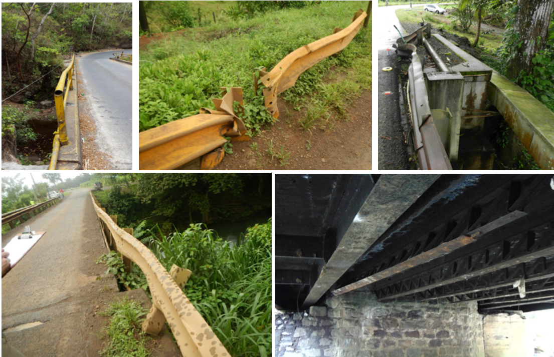
Figura 107. Deformación en barandas y viga principal de acero. Fuente: PEEP (2018).
