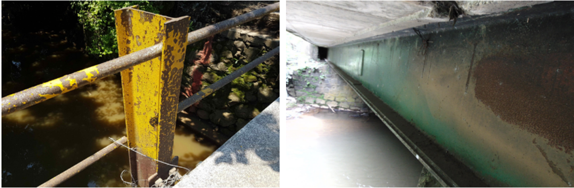
Figura 109. Descascaramiento de la pintura en elementos de acero.
