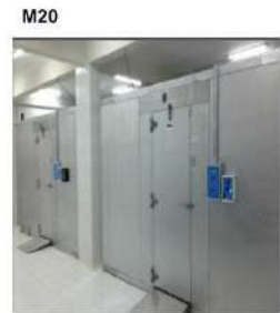
M20 Cámara de refrigeración de vacunas
