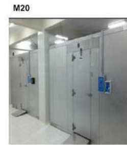
M20 Cámara de refrigeración de vacunas
