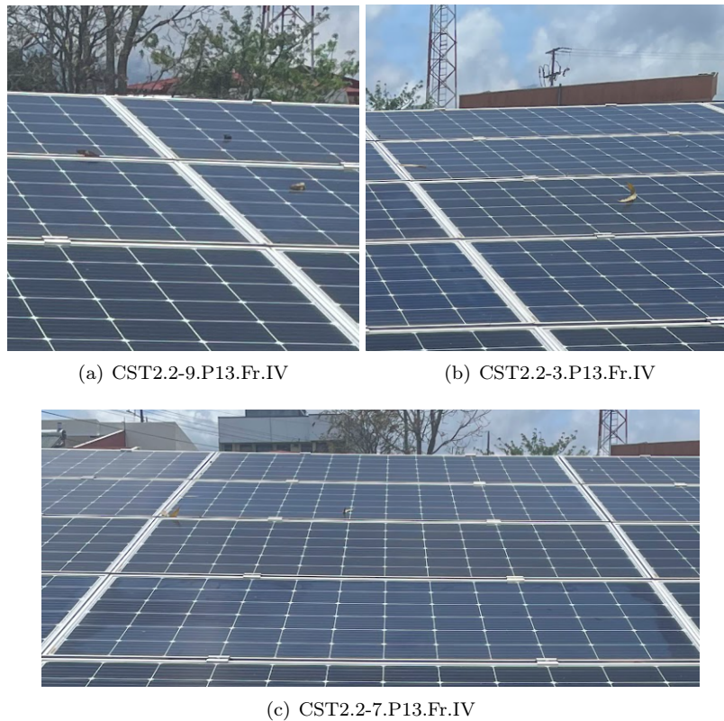
Figura 5.15: Suciedad de difícil acceso dada la altura
