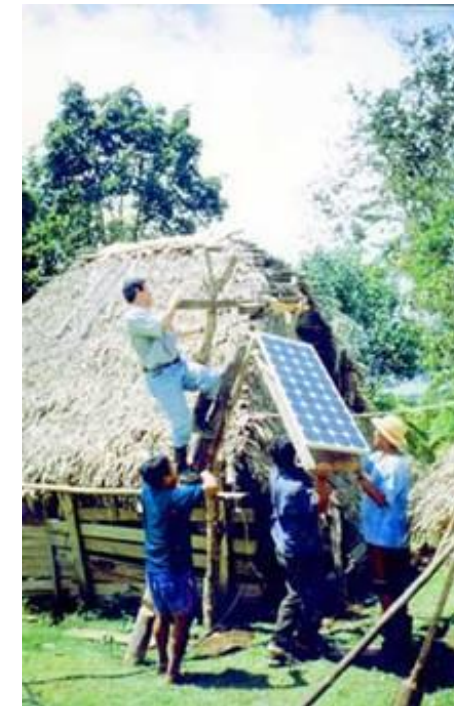
Imagen 67 Generación de Electricidad
