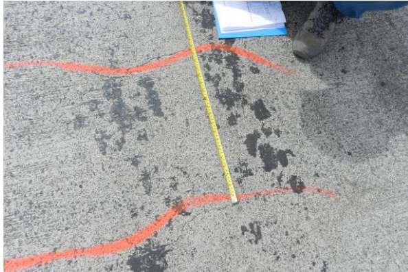
Figura 9. Medición de espaciamiento entre grietas
