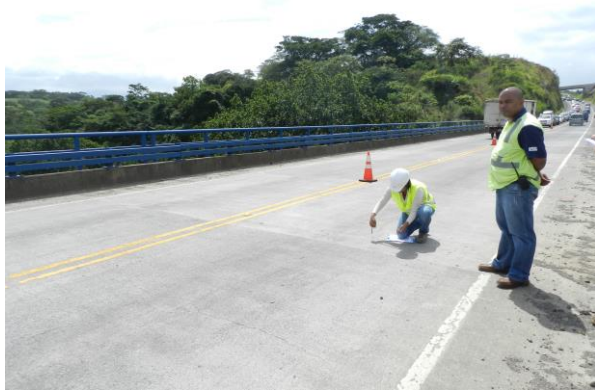
Figura 4. Levantamiento de deterioros.
