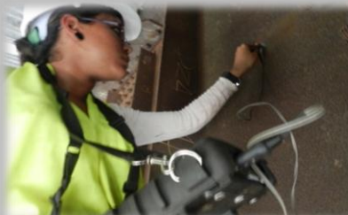
Medición de Espesor
