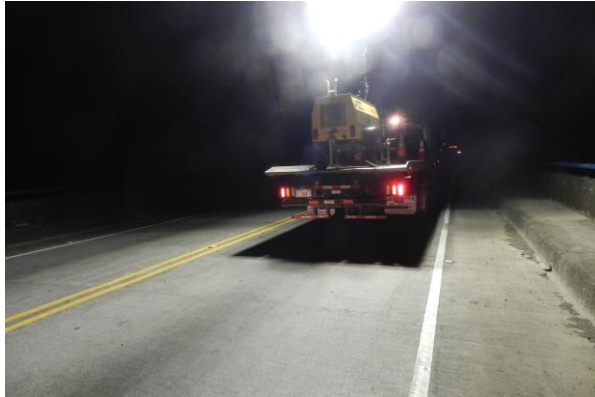
Figura 3. Iluminación en losa del puente sobre río Grande
