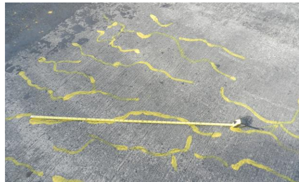
Figura 8. Medición de longitud de grieta
