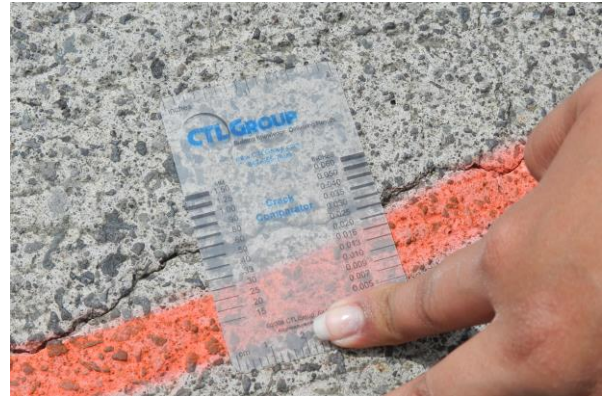
Figura 7. Medición de espesor de grieta
