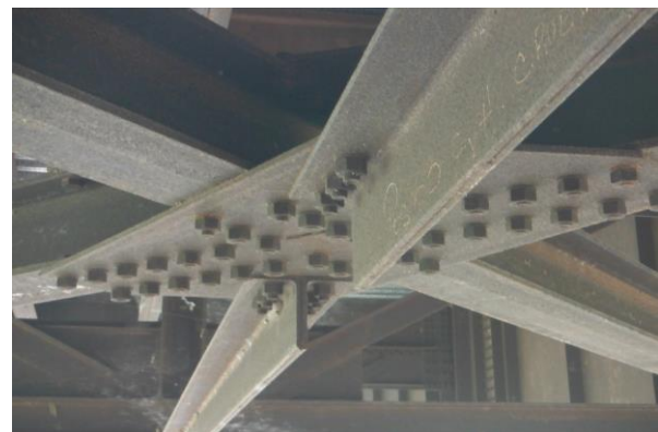
Figura 19. Estado de las conexiones apernadas
