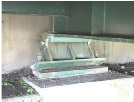
Figura 37. Inclinación de apoyo
