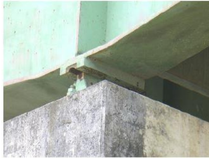
Figura 38. Movimiento del apoyo (grado 5). Fuente: MOPT (2007)
