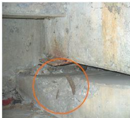
Figura 35. Pernos de anclaje cortado Fuente: MOPT (2007)
