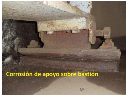
Figura 1. Corrosión en apoyo tipo balancín Fuente: Autor (2015)
