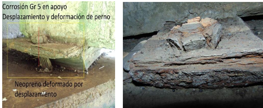
Figura 2. Daños en apoyos no contemplados en Manual de Inspecciones del MOPT Fuente. El Autor (2014.)
