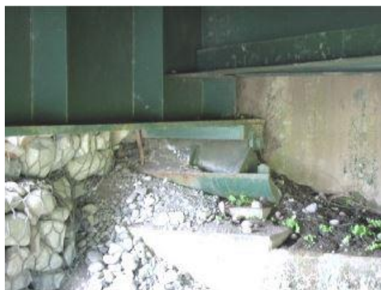
Figura 36. Deformación del apoyo (grado 5) Fuente: MOPT (2007)
