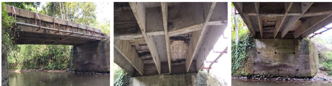
Figura 36. a) Vista general de puente n.º 15, b) Daños 1 y 2 y c) Daño 3
