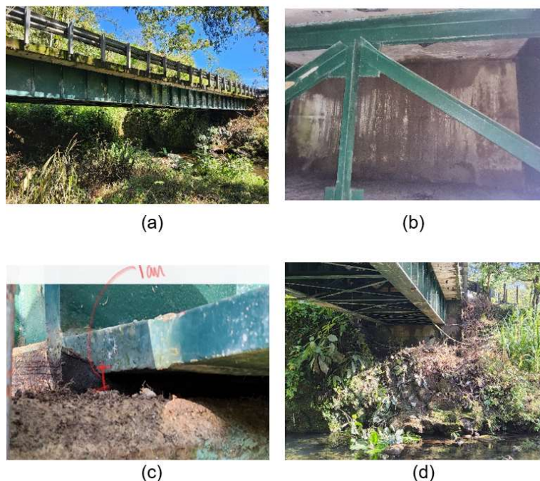
Figura 22. a) Vista general de puente 1, b) Daño 1, c) Daño 3 y d) Daño 4
