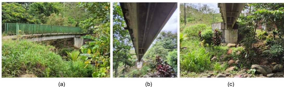
Figura 26. a) Vista general de puente n.º 5, b) Vista inferior 1 y c) Vista de bastión
