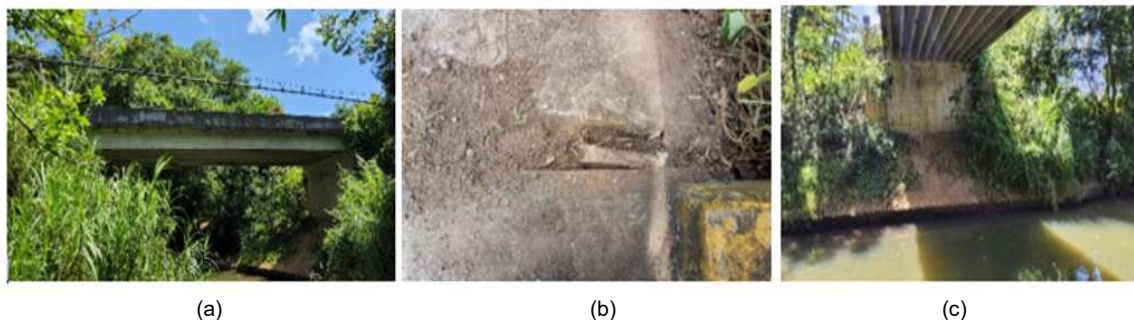
Figura 35. a) Vista general de puente n.º 14, b) Daño 1 y c) Daños 2 y 3
