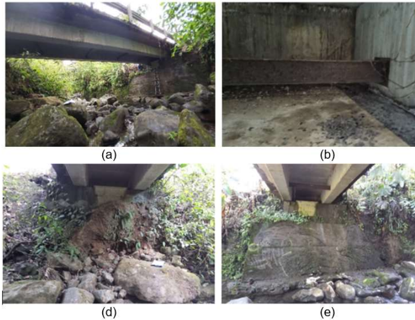
Figura 23. a) Vista general de puente n.º 2, b) Daño 1, c) Daños 2 y 3 y d) Daños 4 y 5
