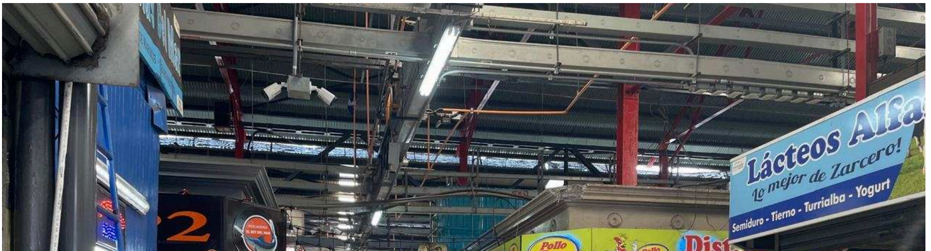
Figura 41. Fotografía de sistemas electromecánicos. (Fuente: Propia, 2025).
