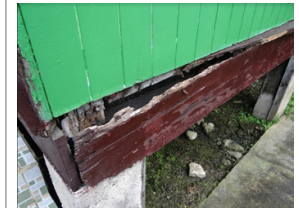
Desprendimiento de material
