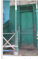
Desprendimientos materiales de acabado
