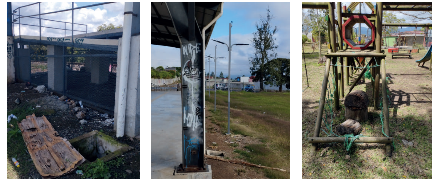
Imagen 57. Estado de estación de tren vandalizada y zona de juegos infantiles en abandono. Fuente: propia.
