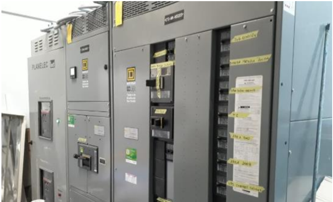
Figura 22. Subestación eléctrica Laboratorios Stein
