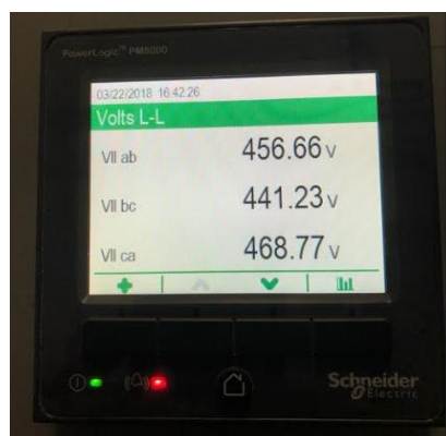
Figura 25. Medición fija de tensión a la entrada de servicio
