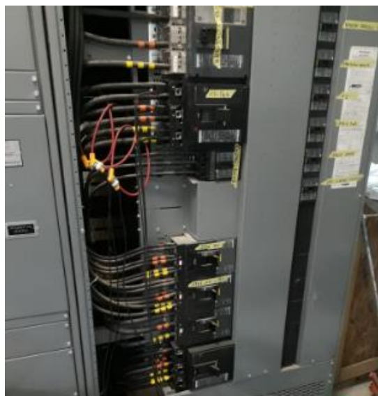
Figura 31. Donas de medición de corriente conectados en el ramal de chiller en subestación
