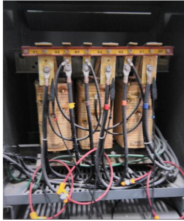
Figura 29. TX-06 Área administrativa, se muestran donas de corriente y conectores para registro de tensión
