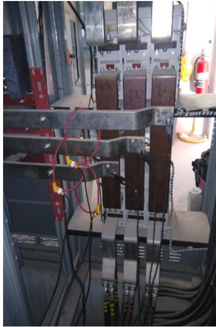
Figura 24. Barras de subestación donde se colocó equipo de medición
